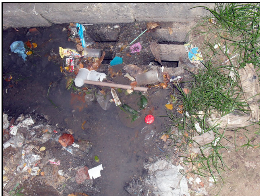
Caixa de ralo de drenagem pluvial obstruída por Lixo
