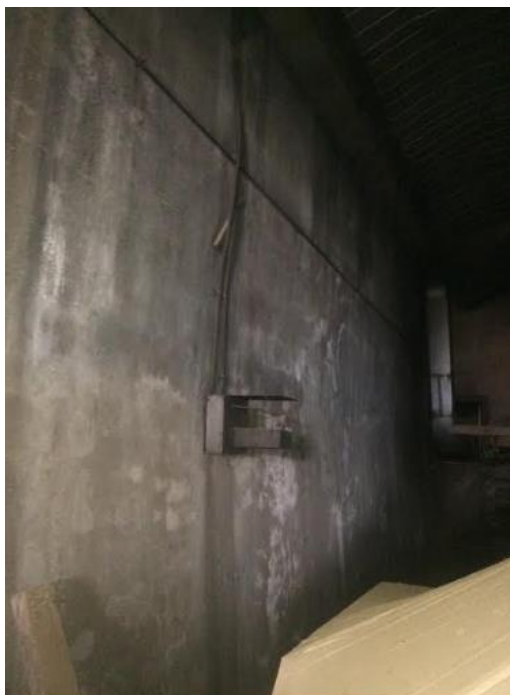
FOTO 07 – Oito recirculadores, (estes ficam acima do teto não possibilitando fotos).
