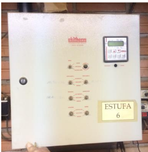
FOTO 12 - Quadro elétrico – 220 volts.
