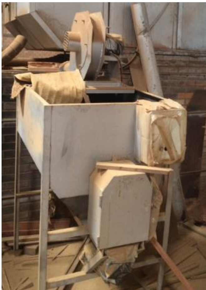
FOTO 11 - Alimentador automático de maravalha
