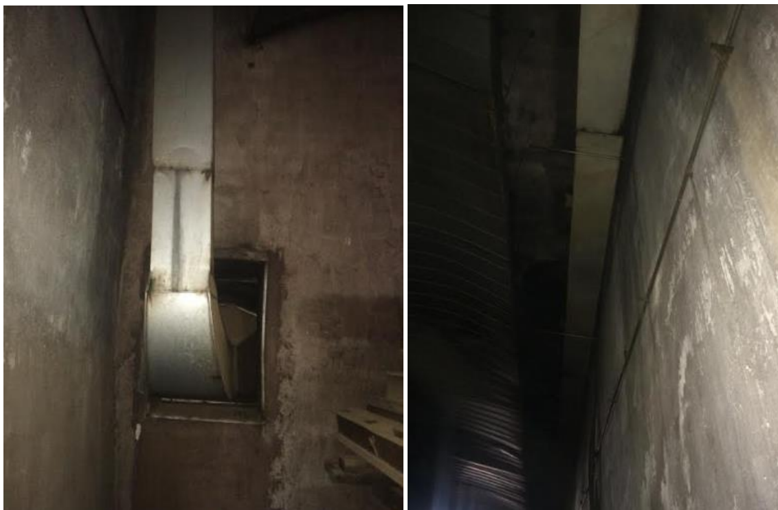
FOTO 14 - Dutos de recirculação.
