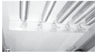
Figura 3: Tensores enganchados hacia abajo
