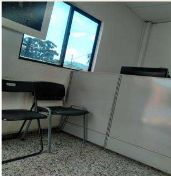
*Vidrio de ventana roto
