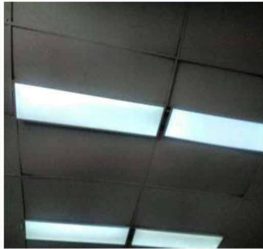
*Riesgo de caída, láminas de drywall.
