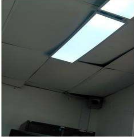
Riesgo de caída de drywall
