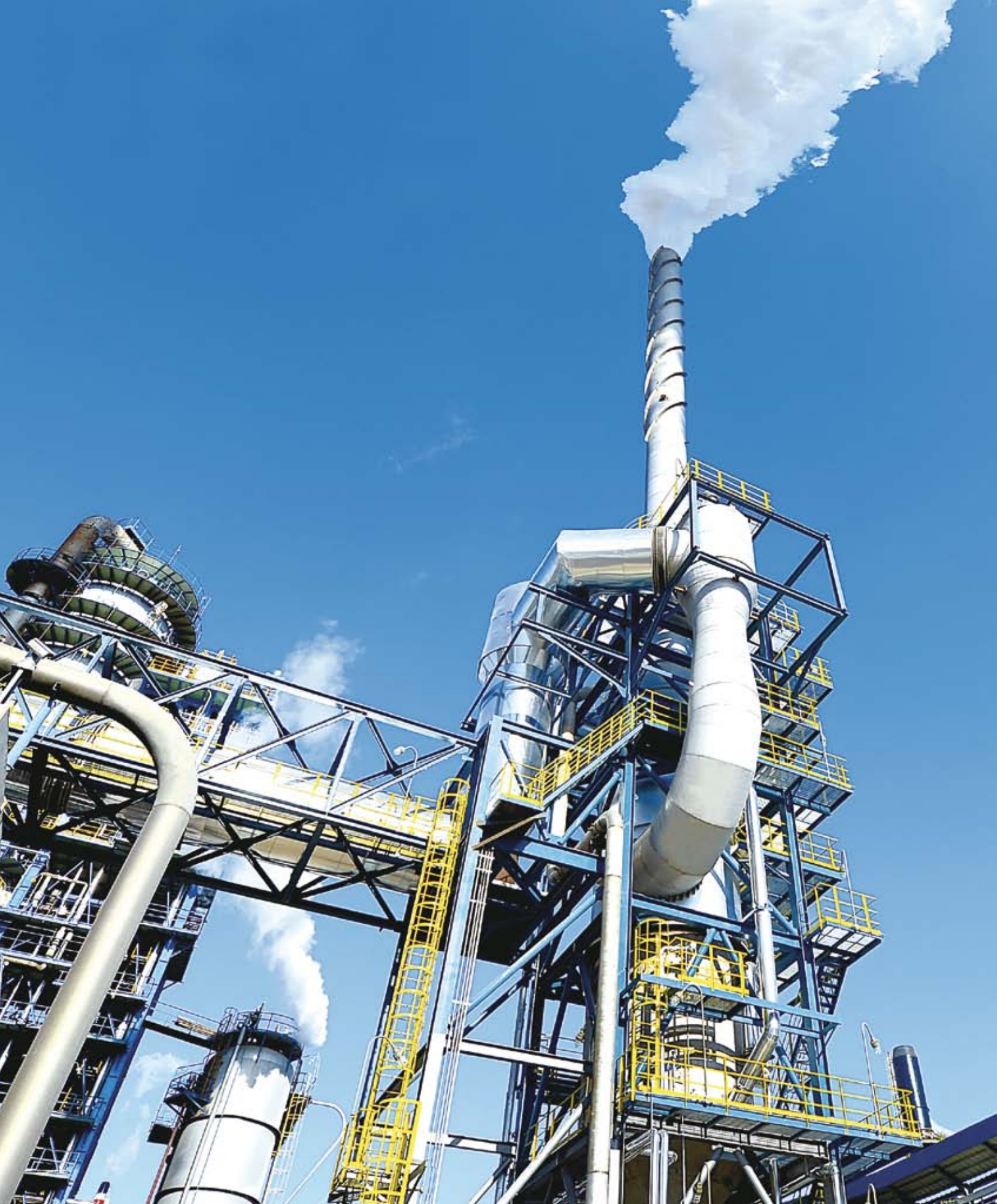
锦西石化烟气净化装置
