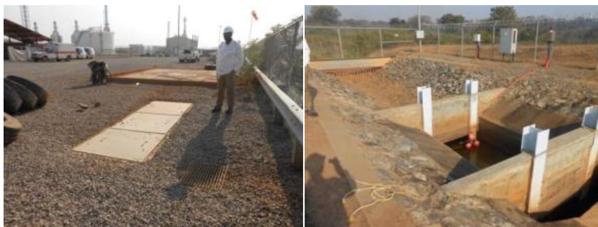
Figure 6.2: Séparateur Hydrocarbures-Eau à la Station PS2
