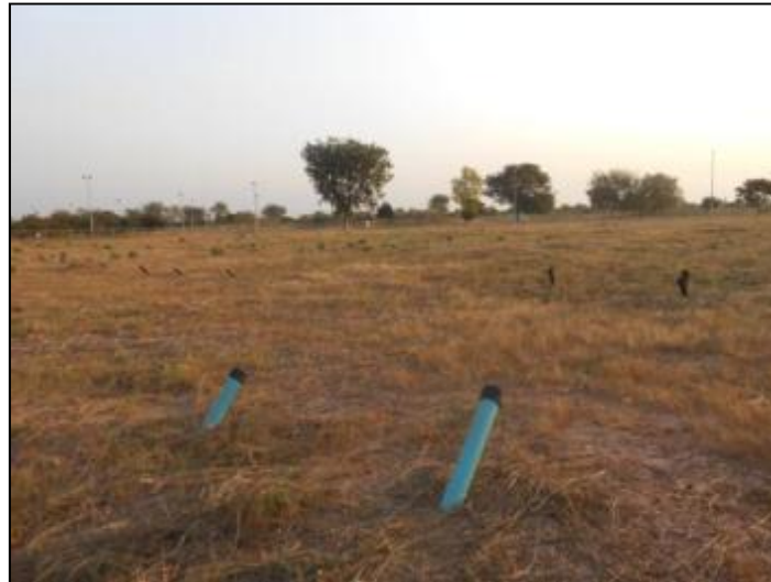
Figure 5.11: Champ d'épandage desservant l'installation de traitement des eaux usées (WWTP) de KFC
