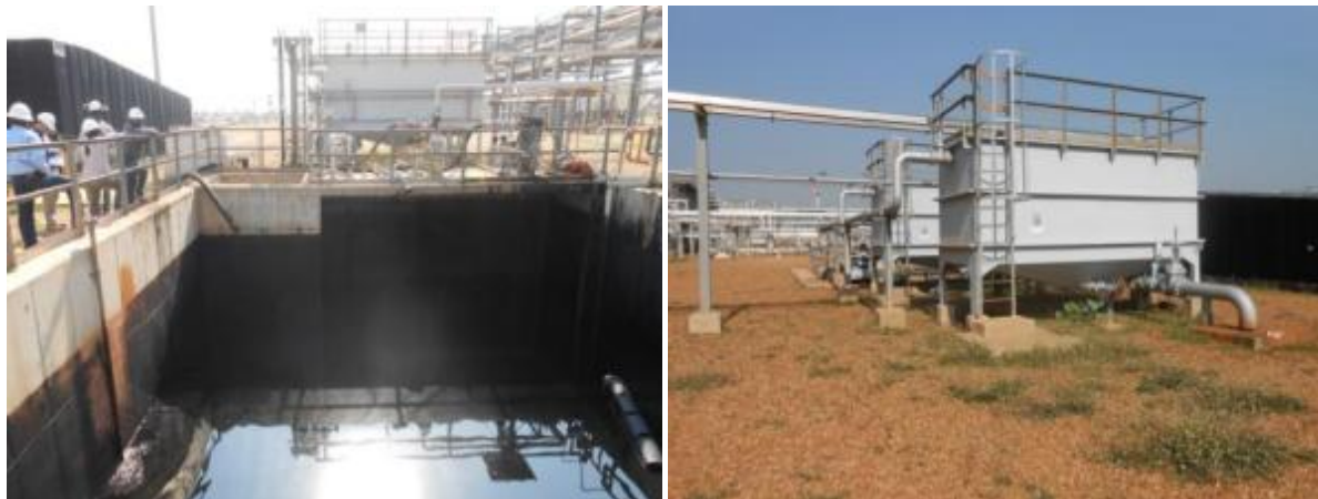
Figure 5.12: Station de relèvement pétrole-eau et unités de séparation hydrocarbures-eau au Site central de traitement CTF
