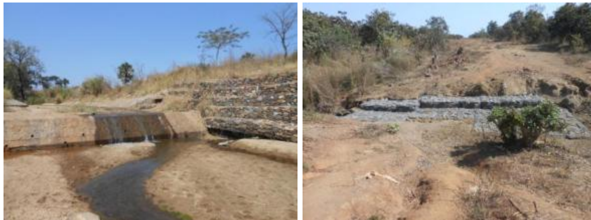
Figure 6.9: Sites de Réparation de l'érosion KP255 et KP241 Visités par ECMG
