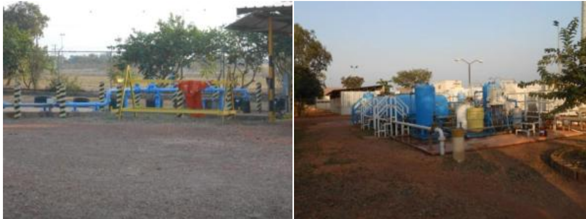
Figure 5.10: Puits d'Eau Potable et Installation de Traitement des Eaux
