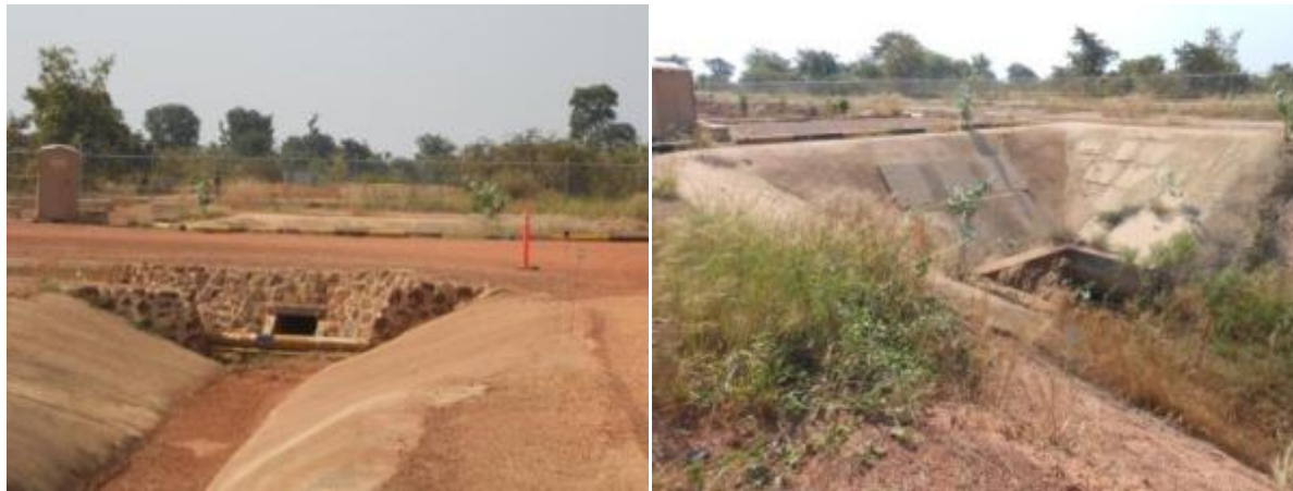
Figure 5.13: Système de drainage des eaux pluviales et Point de prélèvement des échantillons d'eaux pluviales
