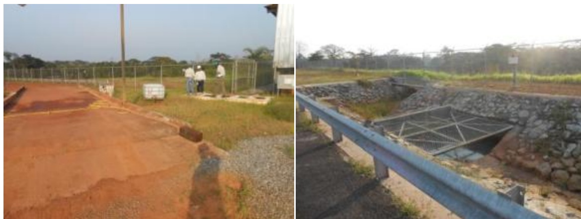
Figure 6.3: Séparateur Hydrocarbures-Eau à la Station PS3
