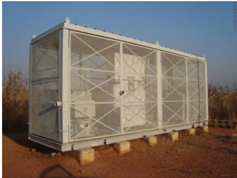
Figure 4.2: Cages Grillagées sur Unité de Transformation dans un Puits Nouvellement Construit
