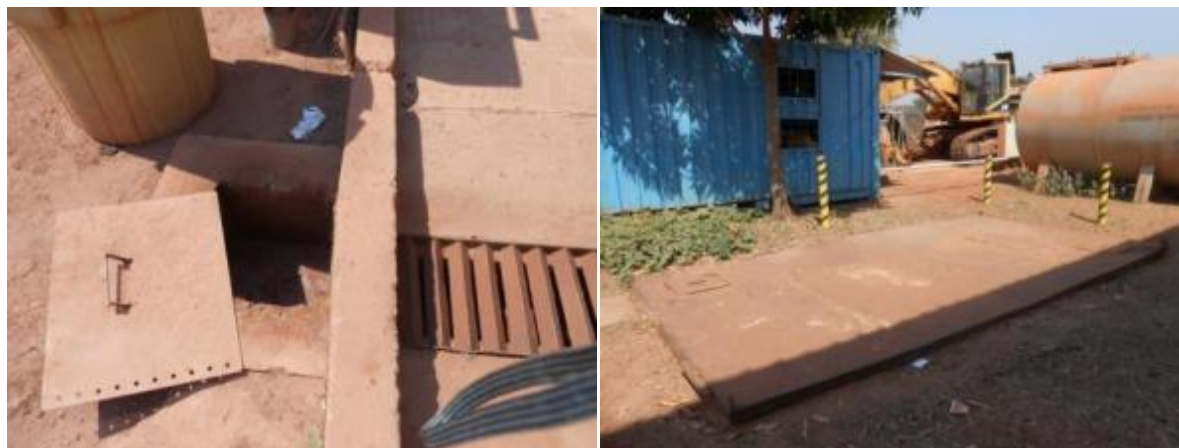
Figure 5.14: Grille de drainage et séparateur hydrocarbures-eau desservant la fosse de lavage à l'atelier d'entretien
