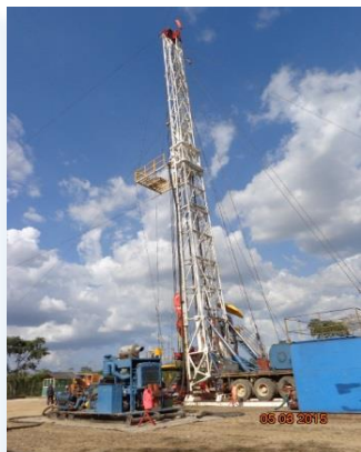
“Intervención Pozo Xan-10” Contrato 2-85
