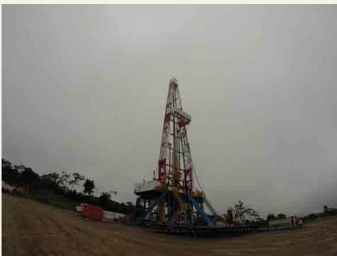
➤ Equipo YPFB-01 en pozo BBL-16D
