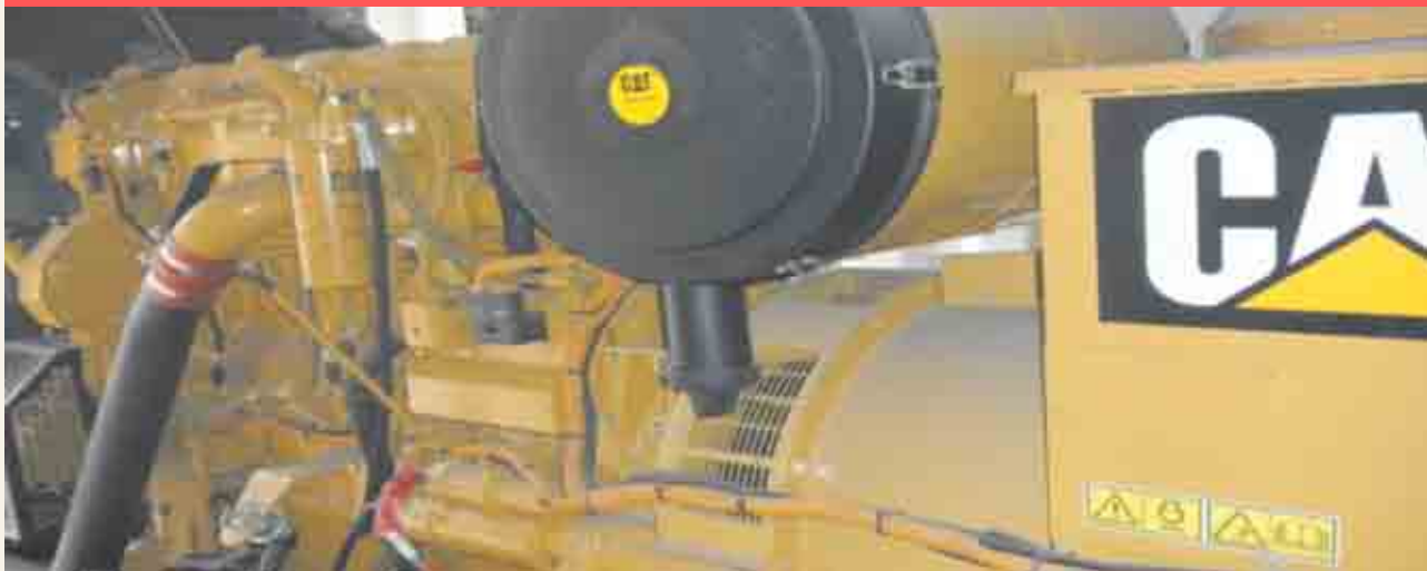
➤ Vista de un motor Caterpillar para generación de energía para el equipo.
