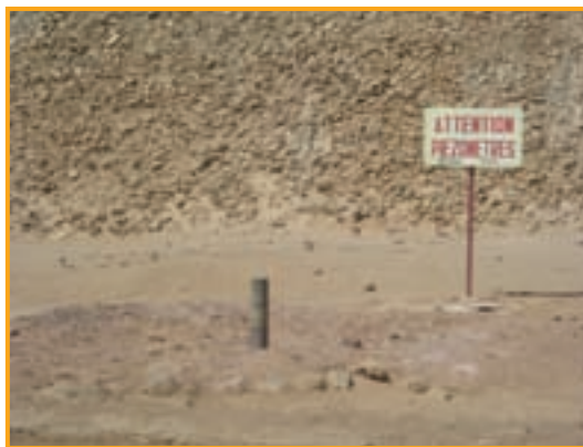
Piezomètre de surveillance
