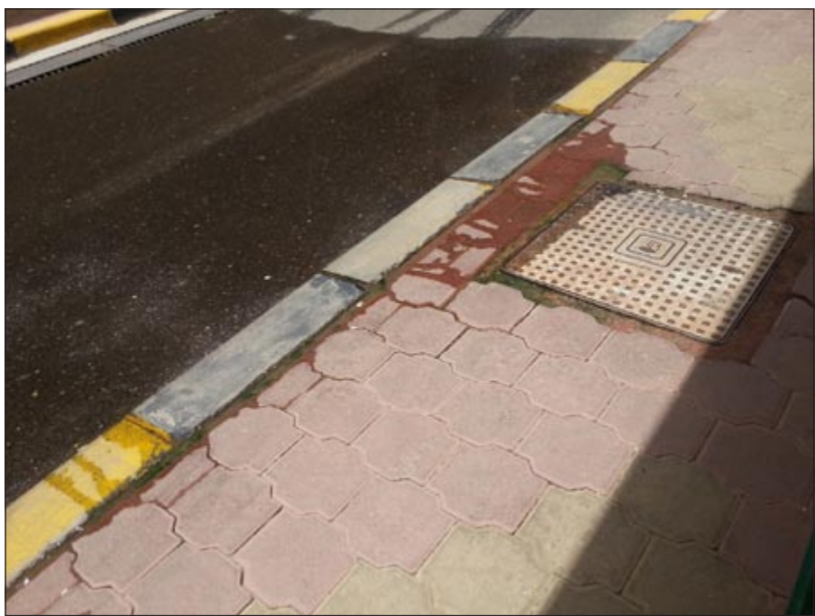
مياه الصرف الصحي مشكلة كبيرة تواجه المدرسة
