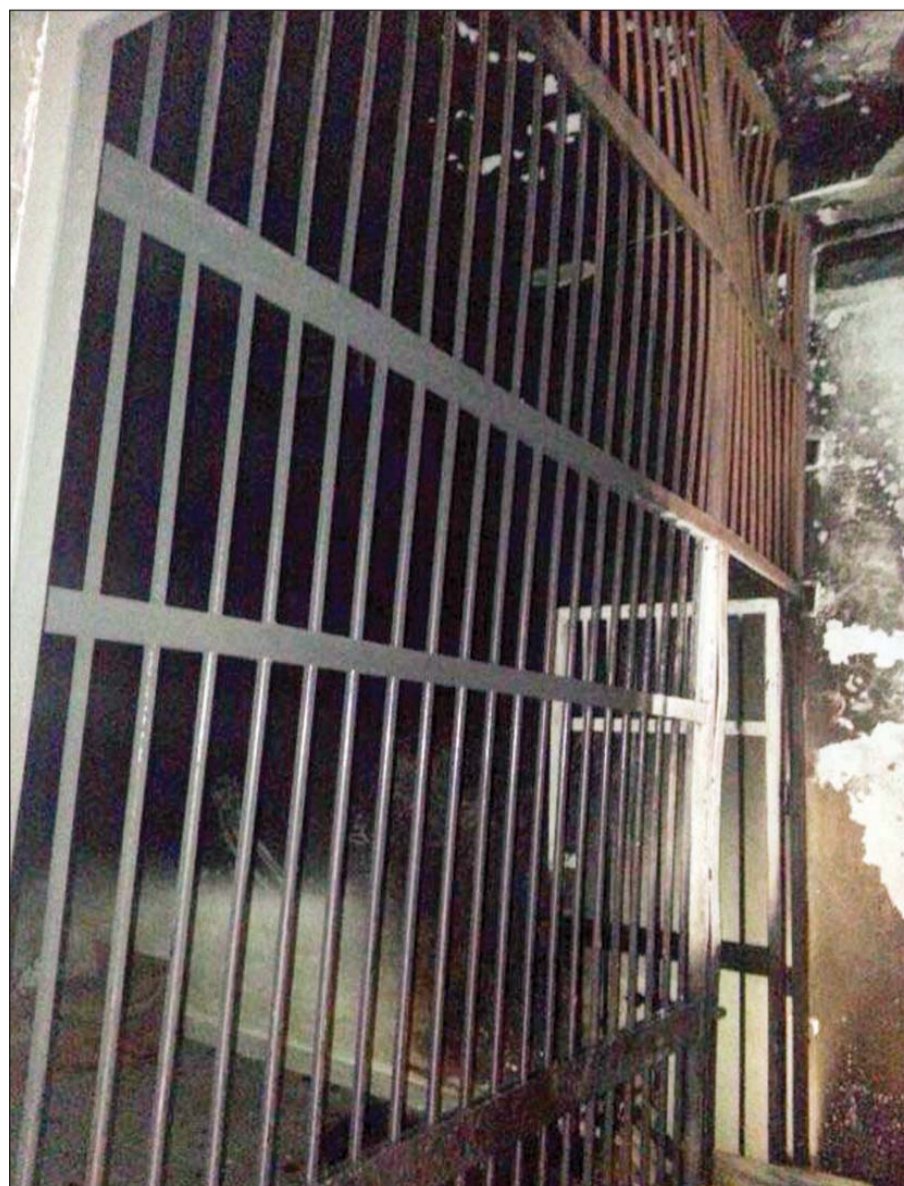
آثار الحريق داخل المخفر
