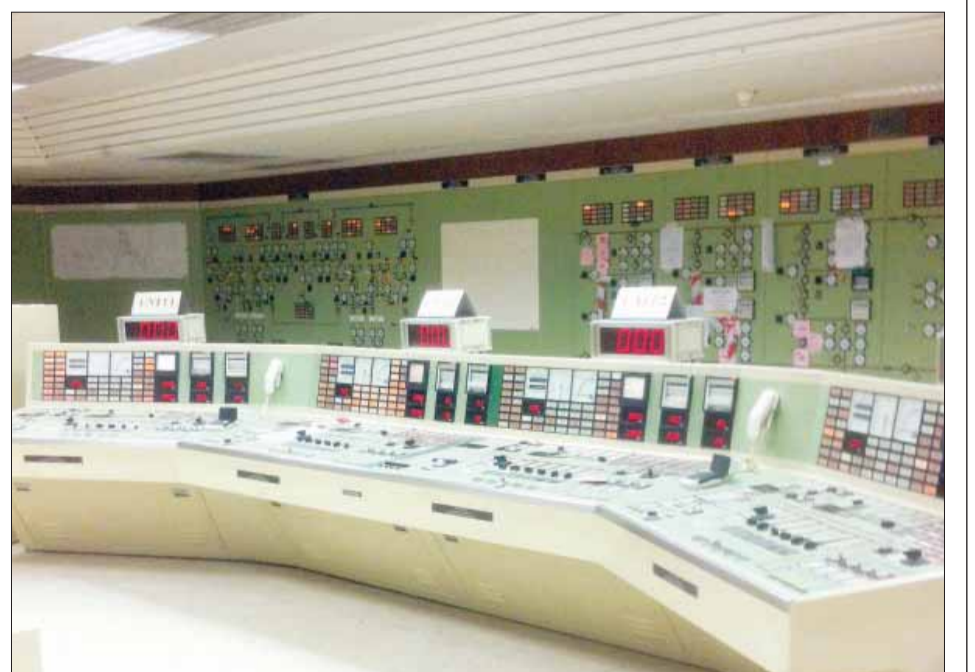
مراقبة وحدات التوليد الكهربائي
