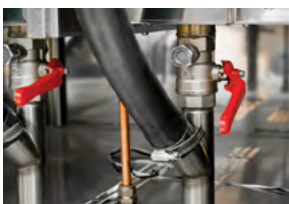
Sistema de escoamento conectado diretamente ao esgoto.
