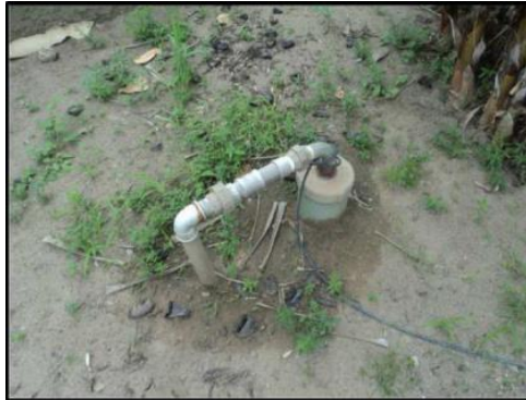
Figura 3.1.34 – Instalações físicas do poço que compõe o sistema de abastecimento de Pitombeira.
