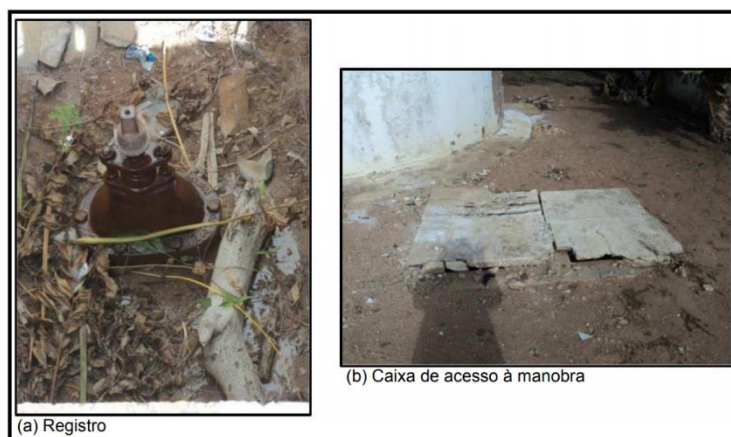
Figura 3.1.10 – Registro e caixa de acesso à manobra para controle de entrada/saída de água do reservatório elevado da sede do município de Vera Cruz.
