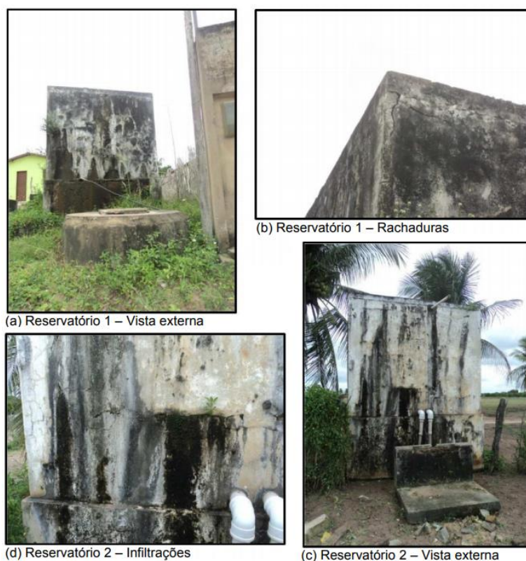
Figura 3.1.26 – Reservatórios da comunidade Araça II.
