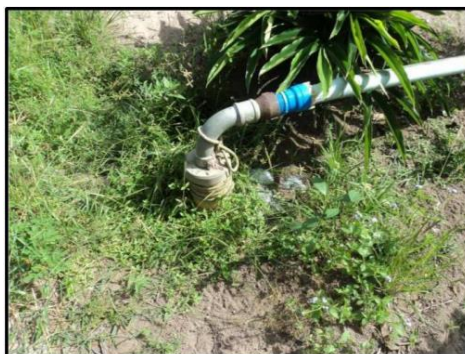
Figura 3.1.38 – Poço que integra o sistema de abastecimento da comunidade dispersa Areias.
