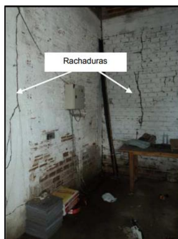
(b) Vista casa de comando elétrico
