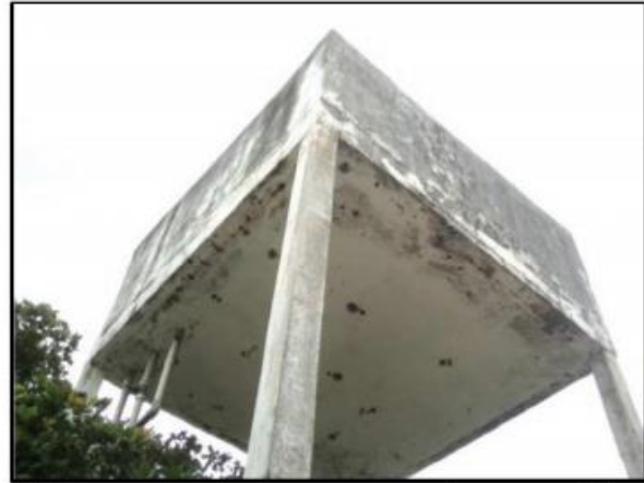
(b) Fissuras/rachaduras no encontro com a laje
