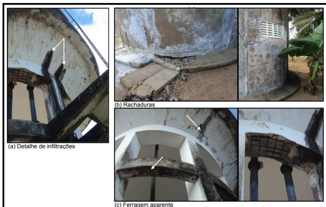
Figura 3.1.8 – Condições estruturais do reservatório elevado da sede do Município de Vera Cruz.
