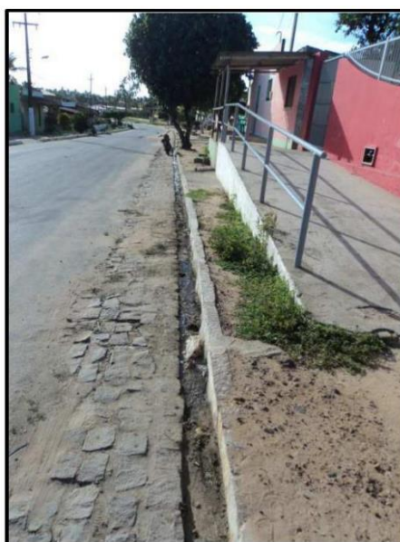
Figura 3.2.2 – Índícios de águas cinza sendo despejadas nos dispositivos de drenagem (sarjeta) no distrito Cobé.
