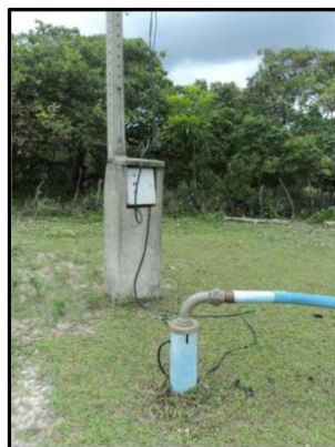
Figura 3.1.28 – Instalações físicas do poço que compõe o sistema de abastecimento de Jacaré, Assentamento Riacho do Feijão e Ponta de Várzea.
