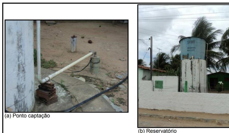
Figura 3.1.11 – Componentes do sistema de abastecimento de água (poço e reservatório) operado pela Prefeitura na área urbana do Município de Vera Cruz.
