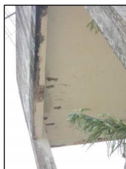
(b) Infiltração/fissuras/ferragem exposta
