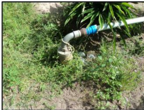
Figura 3.1.22 – Instalações físicas do poço que compõe o sistema de abastecimento de Araça I.
