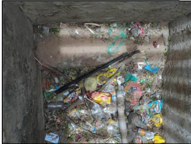
Figura 3.1.18 – Caixa de acesso à manobra do SAME no Sítio Santa Cruz.
