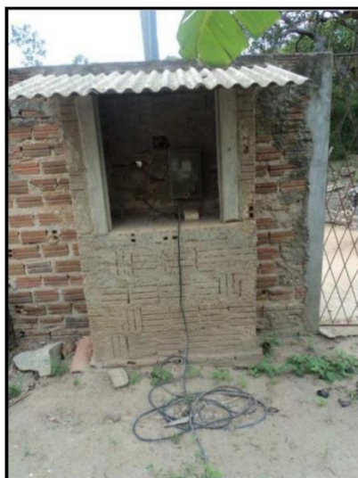
Figura 3.1.36 – Casa de comando elétrico do poço que integra o sistema de abastecimento da comunidade Pitombeira.
