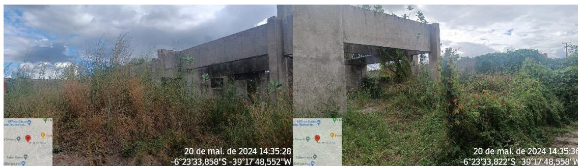
Figura 6 e 7 – vegetação indesejada no entorno da edificação. Fonte: elaboração própria
