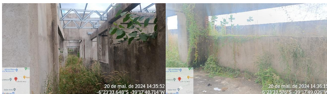
Figura 10 e 11 – fissuras no contra piso e rebocos. Fonte: elaboração própria
