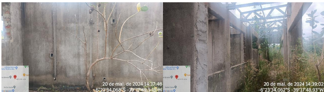
Figura 15 e 16 – Ambientes com vegetação e deterioração de reboco. Fonte: elaboração própria.
