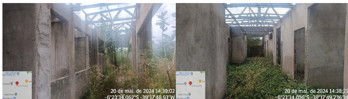
Figura 8 e 9 – vegetação indesejada no encontro de parede e no piso. Fonte: elaboração própria
