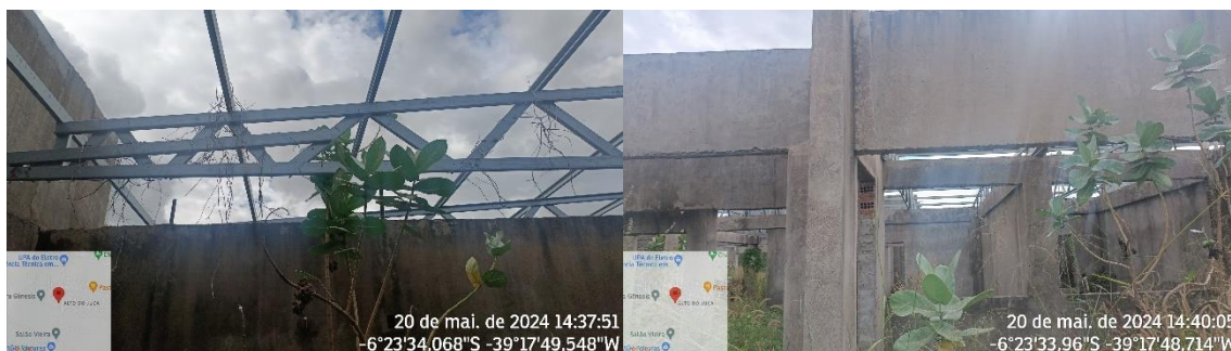
Figura 21 e 22 – Vegetação nos ambientes da edificação e estrutura metálica. Fonte: elaboração própria.
