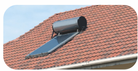
● Coletor solar instalado no telhado de uma residência.
