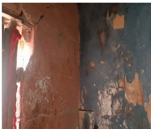
Residência com risco de desabar
