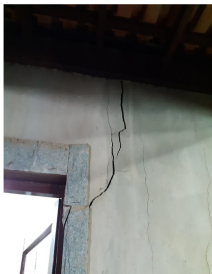
Casa com muitas trincas
