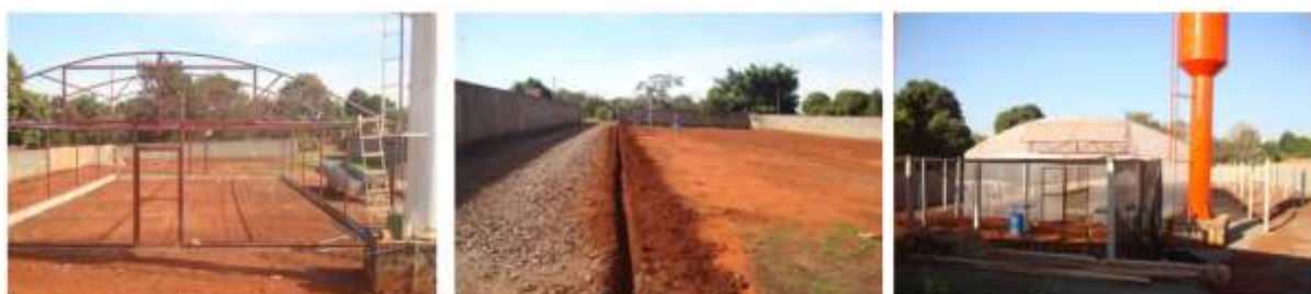
Figura 2. Imagens de uma fase da construção do Viveiro Municipal “Flora do Cerrado”, Campo Grande, Mato Grosso do Sul.
