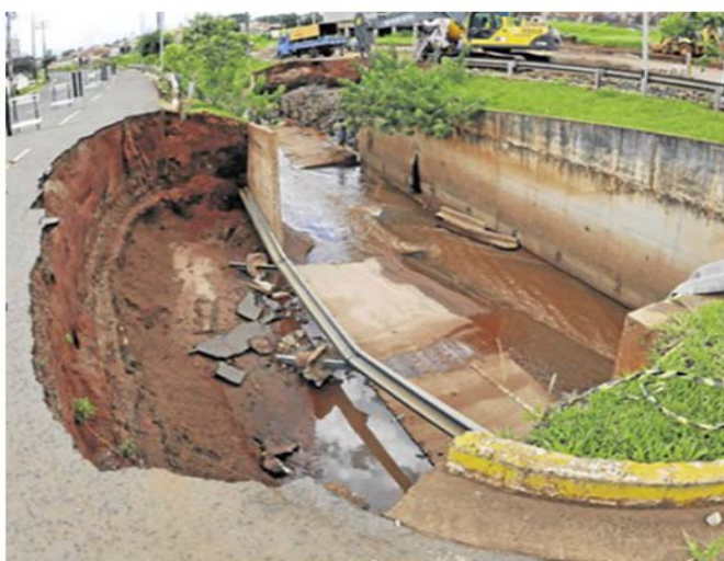
Figura 6. Desmoronamento ocorrido na Avenida Presidente Ernesto Geisel. Fonte: CORREIO DO ESTADO, 2011
