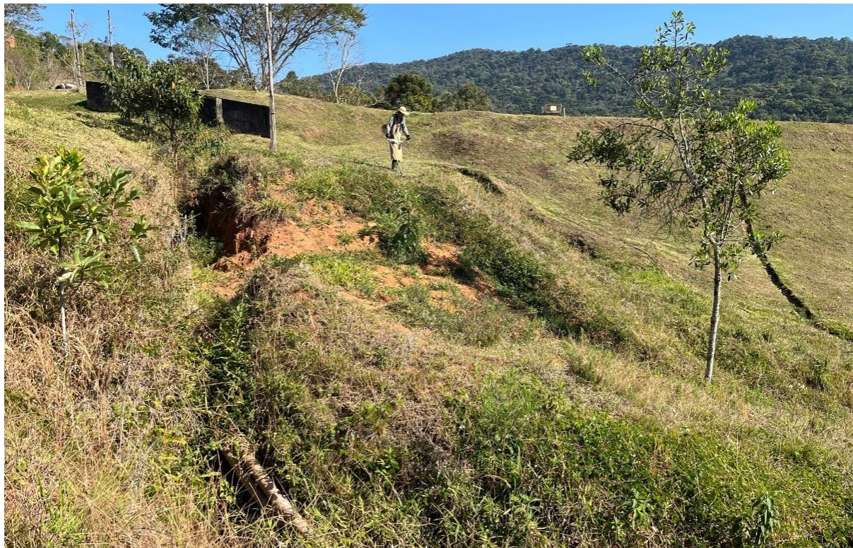
Foto 39. Vertedor – erosões na região de jusante.
