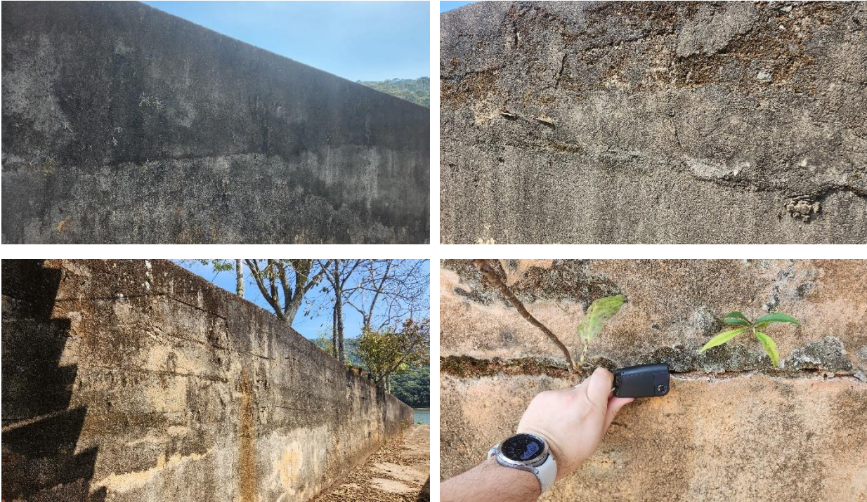
Foto 40. Anomalias encontradas na estrutura do vertedor, tais como deterioração da superfície de concreto, com ocorrência de armaduras expostas e com corrosão, e crescimento de musgos e vegetação na parede de concreto.
