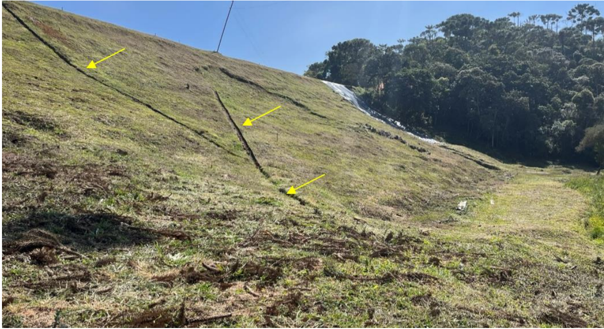
Foto 17. Sistema de drenagem inadequado.
