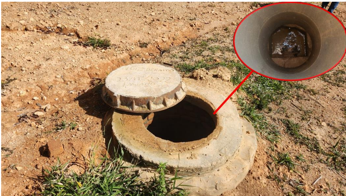
Foto 33. Poço de visita entre a tubulação de concreto e a tubulação do MND.
