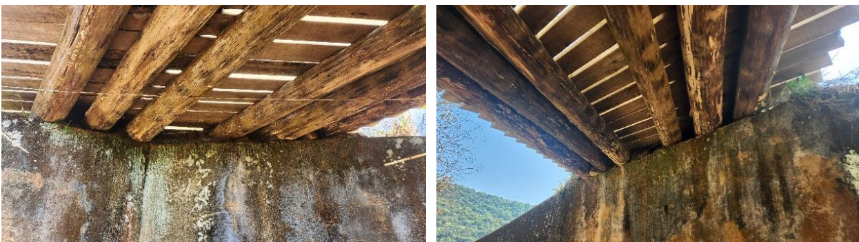
Foto 41. Ponte de madeira sobre o vertedor, com sinais de apodrecimento das vigas.
