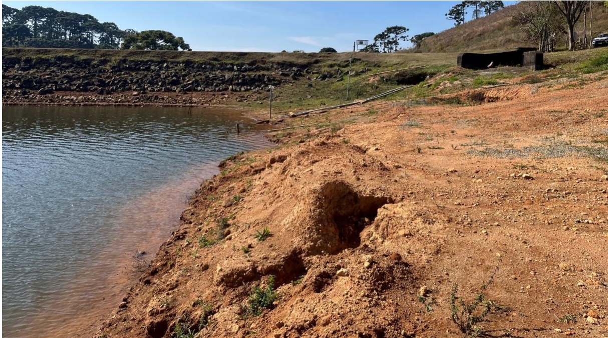
Foto 44. Erosões próximo a ombreira direita
