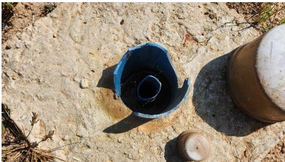
Foto 30. Medidores de nível d'água instalados na crista.
