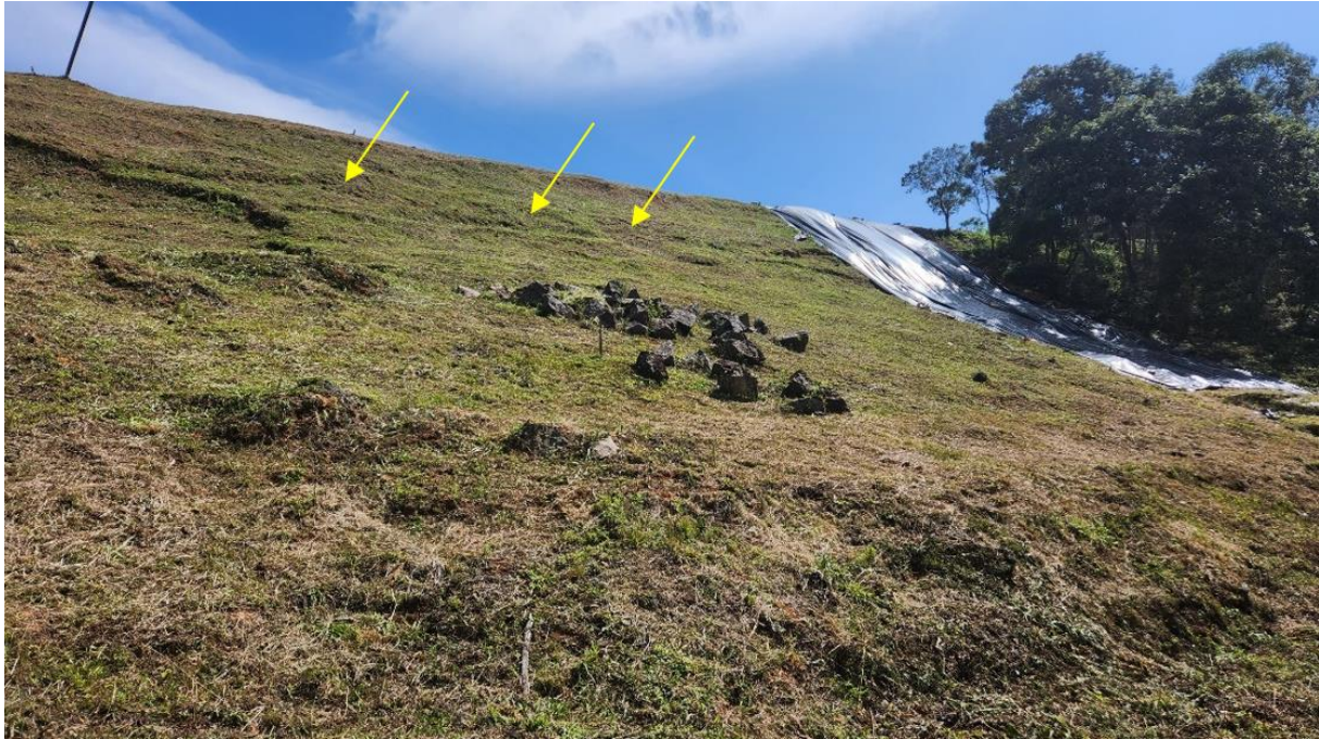
Foto 11. Marcas de rastejo no talude de jusante.
