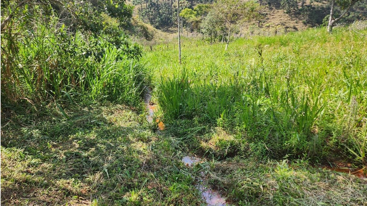
Foto 29. Exarco a frente do filtro, próximo a ombreira esquerda.
