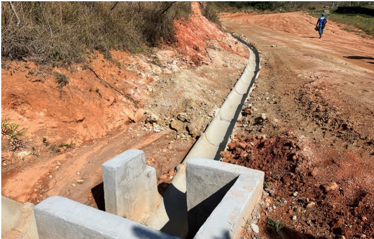
Foto 24. Ombreira direita – Drenagem próxima ao encontro com o talude de jusante.
