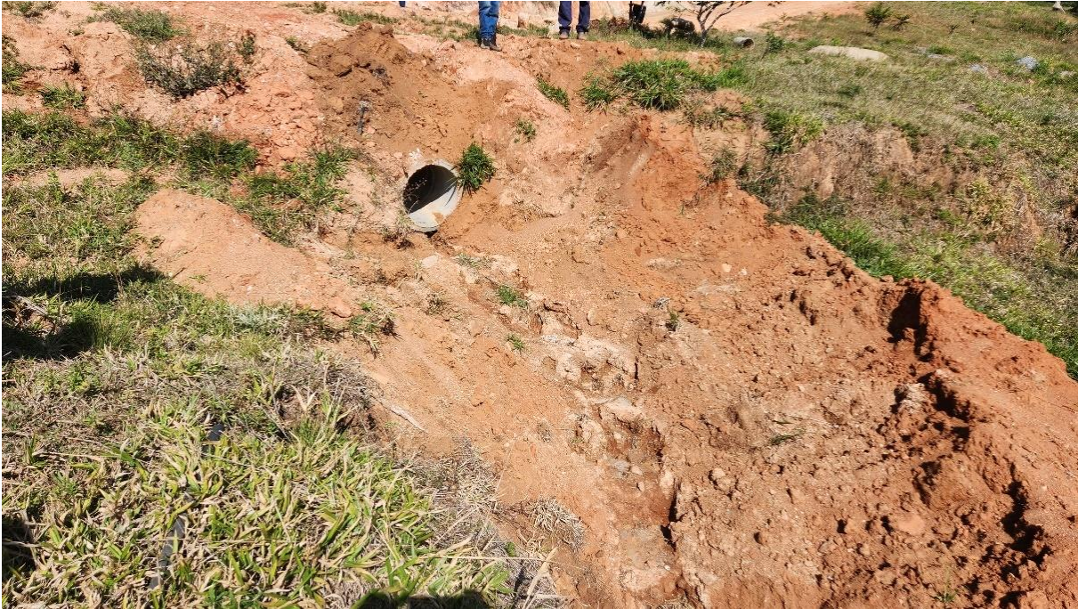
Foto 25. Ombreira direita. – Saída da =drenagem próxima ao encontro com o talude de jusante.
