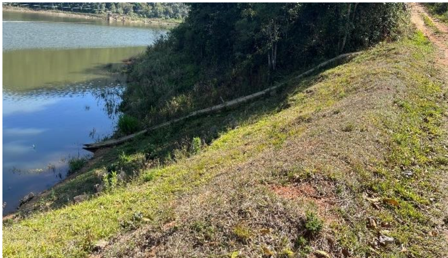
Foto 5. Dispositivos de drenagem improvisados.
