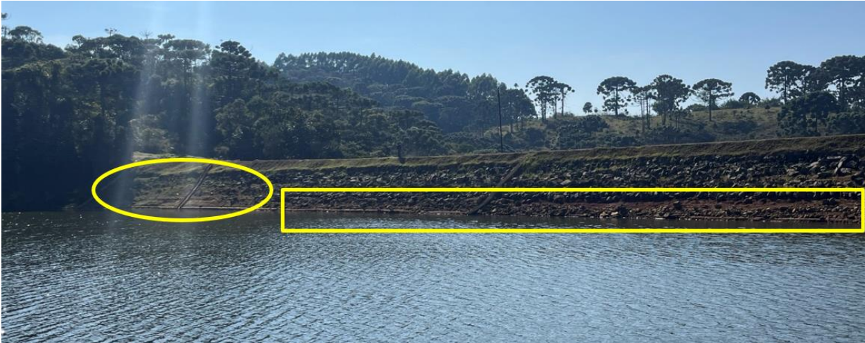
Foto 3. Talude geral do talude de montante a partir da tomada d'água. Destaque para trechos com falhas no rip-rap.
