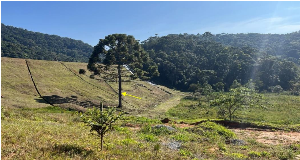
Foto 18. Vegetação de grande porte no talude de jusante.
