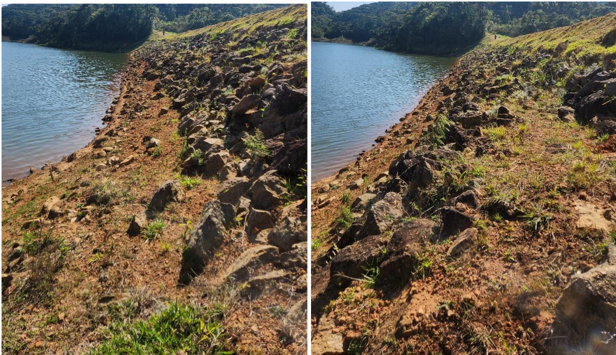
Foto 4. Falha na proteção granular do paramento de montante.
