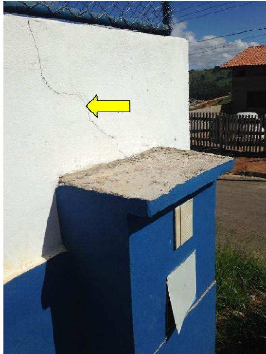
Foto 5 – Tricas a 45° no sentido do deslocamento horizontal (arrastamento).
