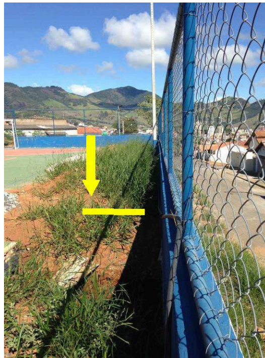
Foto 2 – Fresta entre a borda superior do muro e o limite da quadra ocasionada pelo deslocamento do muro.
