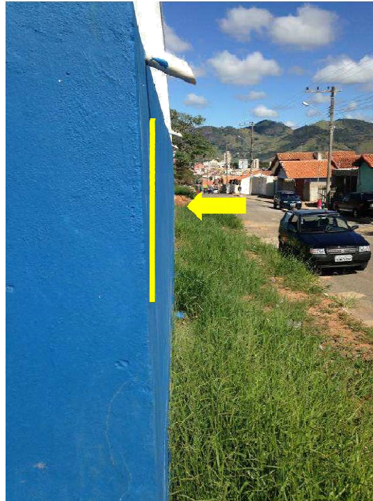
Foto 1 – Inclinação vertical do muro no centro
