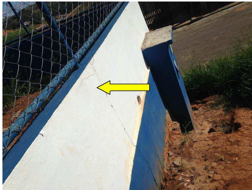
Foto 6 - Tricas a 45° no sentido do deslocamento horizontal (arrastamento).
