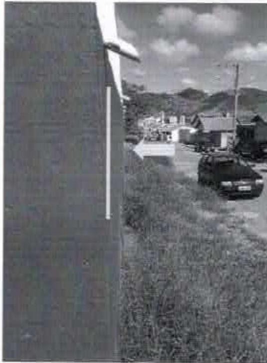
Foto 1 – Inclinação vertical do muro no centro
