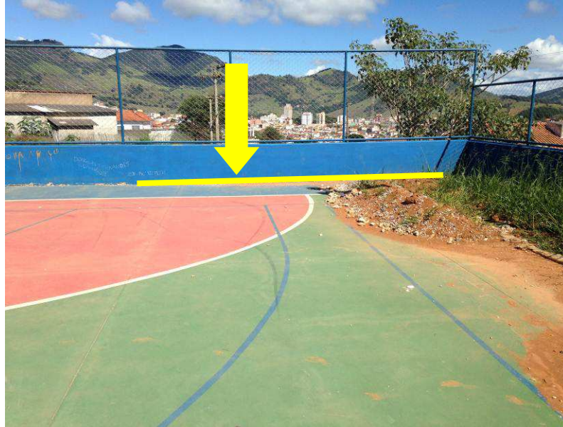
Foto 3 – Inclinação do piso no sentido do limite com o muro indicando a movimentação horizontal e inclinação vertical do mesmo.
