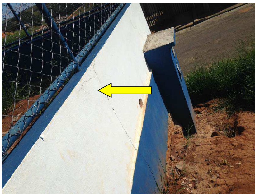
Foto 6 - Tricas a 45° no sentido do deslocamento horizontal (arrastamento).
