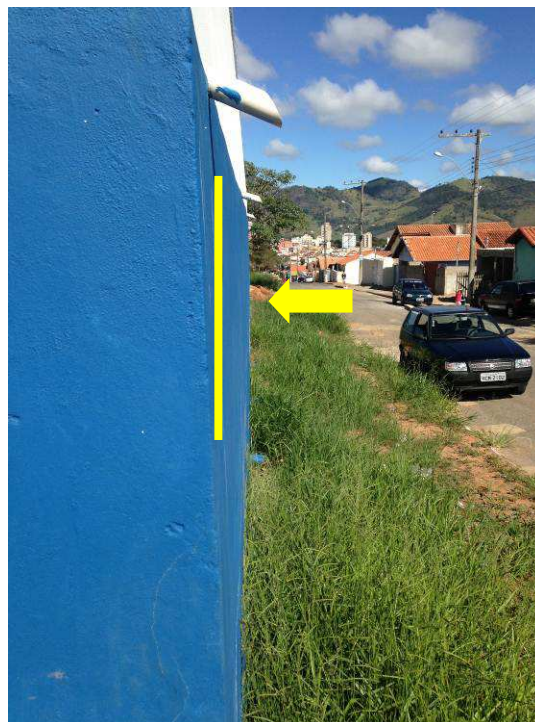
Foto 1 – Inclinação vertical do muro no centro
