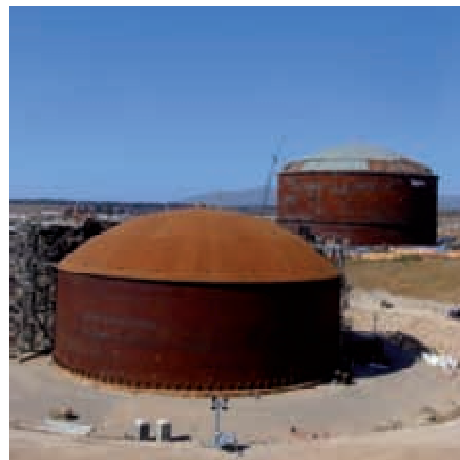
METROGAS, TERMINAL MARÍTIMO GNL
