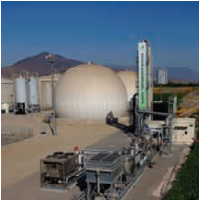
METROGAS, PLANTA BIOGÁS
