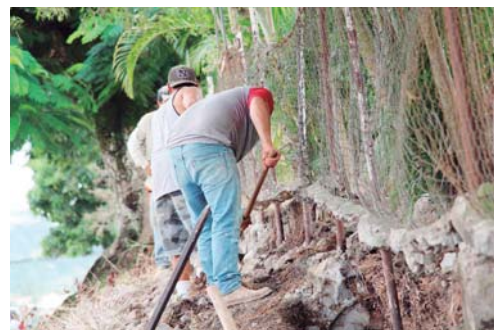
Raíces de los árboles de acacias y macuelizos dañaron el muro que se está demoliendo para construir uno nuevo.
