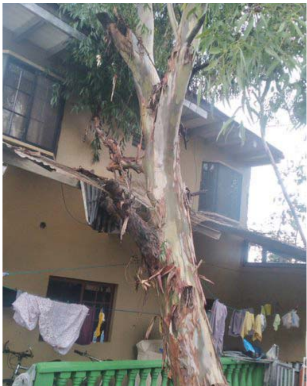
En la colonia 2 de Marzo las lluvias provocaron el desprendimiento de un árbol que cayó sobre una casa.
