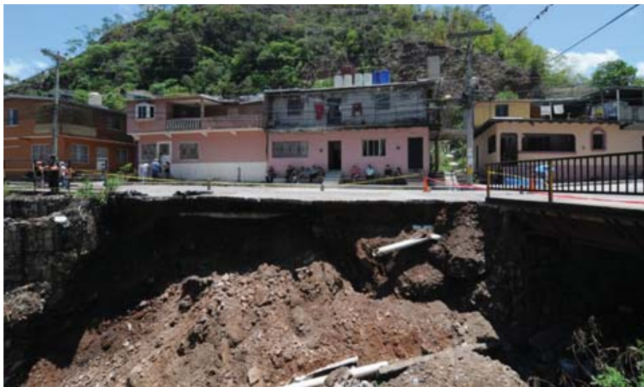
Varias casas de la colonia la Kasandra quedaron a punto de derrumbarse por las aguas de la quebrada.
