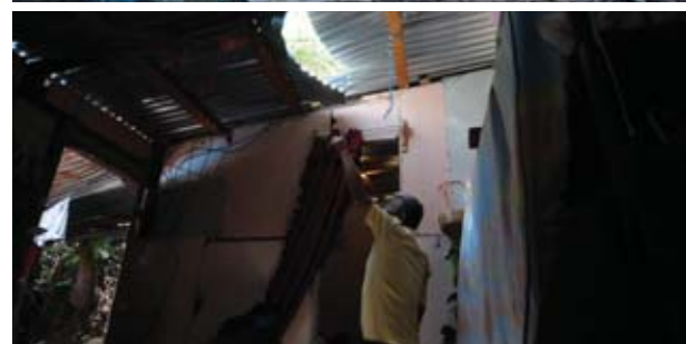
Carlos Antonio López, vecino del barrio El Bosque, mostró a LA TRIBUNA cómo las lluvias dañaron su casa, al desprender rocas que cayeron sobre el techo.
