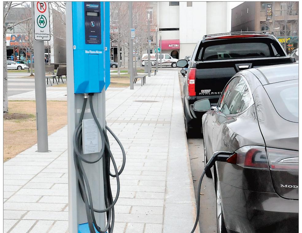
Les bornes de recharges électriques du centre-ville ont été utilisées 789 fois en 2013.
