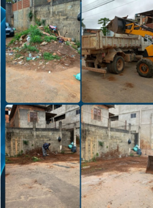
RETIRADA DE ENTULHO IRREGULAR Rua Leite, Jardim dos Reis
