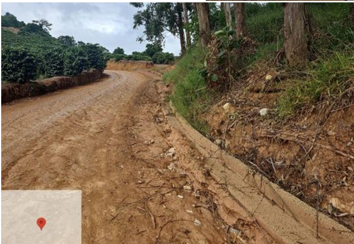
Figuras 4 a 5- Fotos retirada na vistoria Fonte: Divisão de Meio Ambiente, 2025
