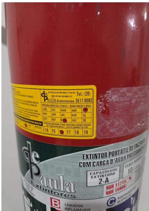
Foto 15 – Extintor vencido 11/2014 – Alegre
