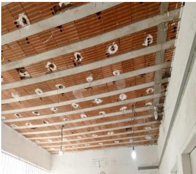
Foto 9 - Teto do corredor, sem reboco e com mofo - Sooretama
