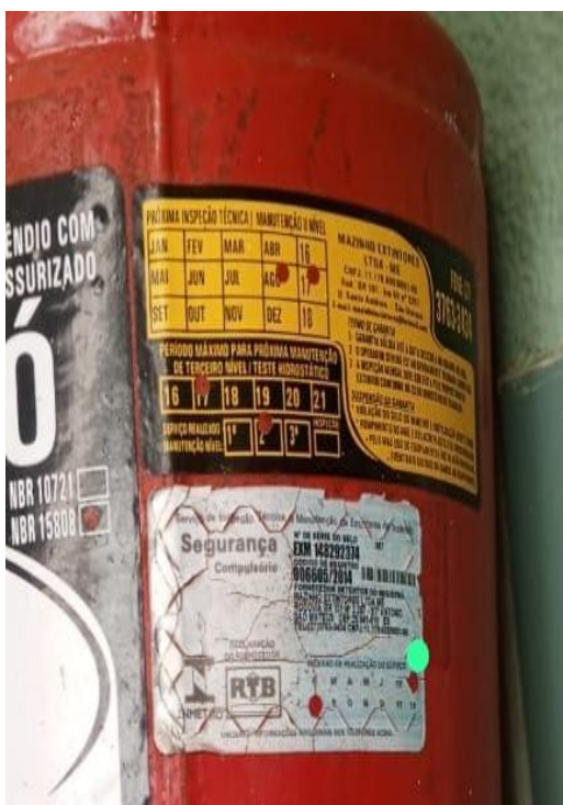
Foto 16 – Extintor vencido 8/2017 – Vila Valério
