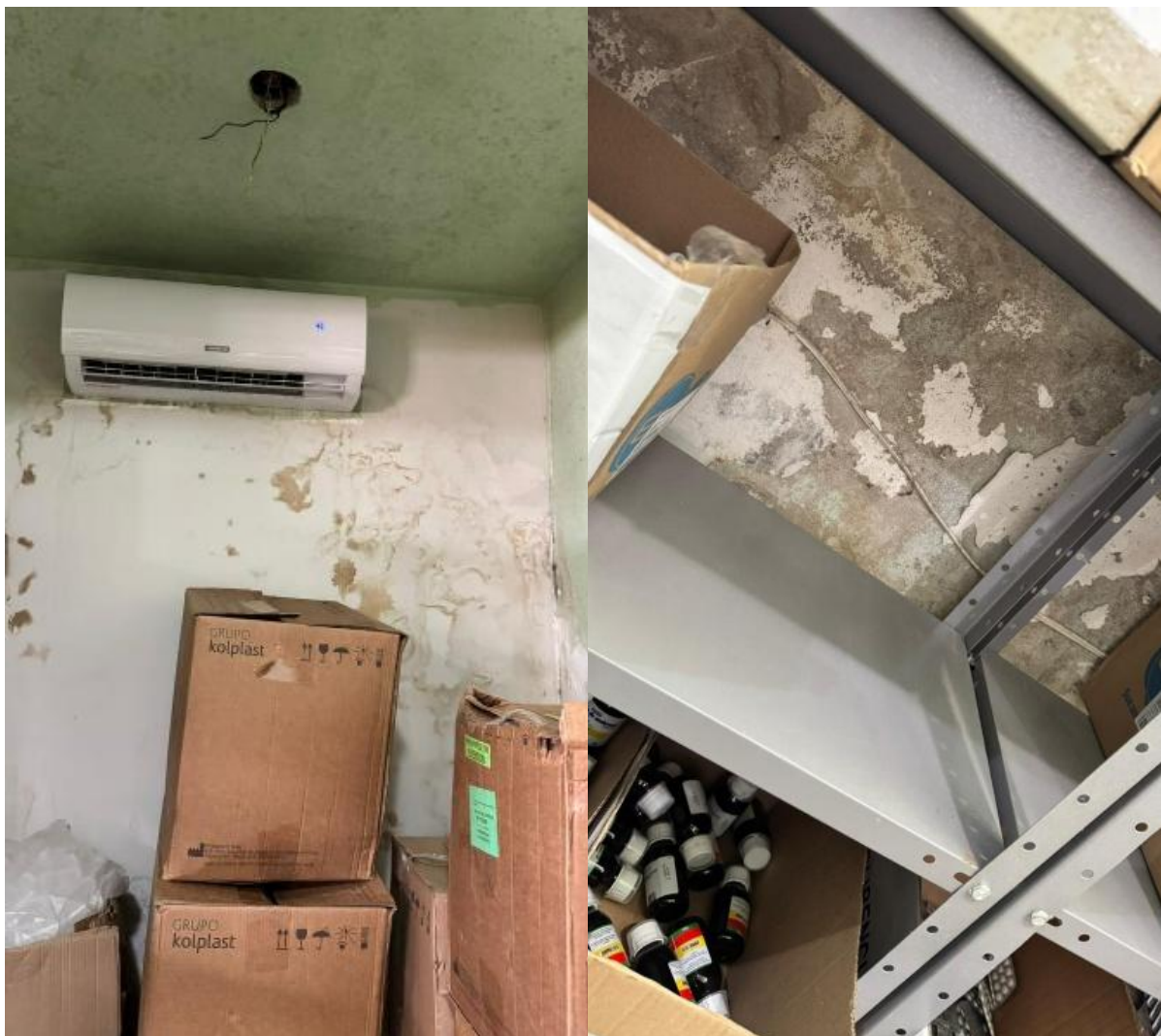
Foto 19 – Paredes com mofo e infiltrações e fiação exposta na farmácia – Água Doce do Norte
