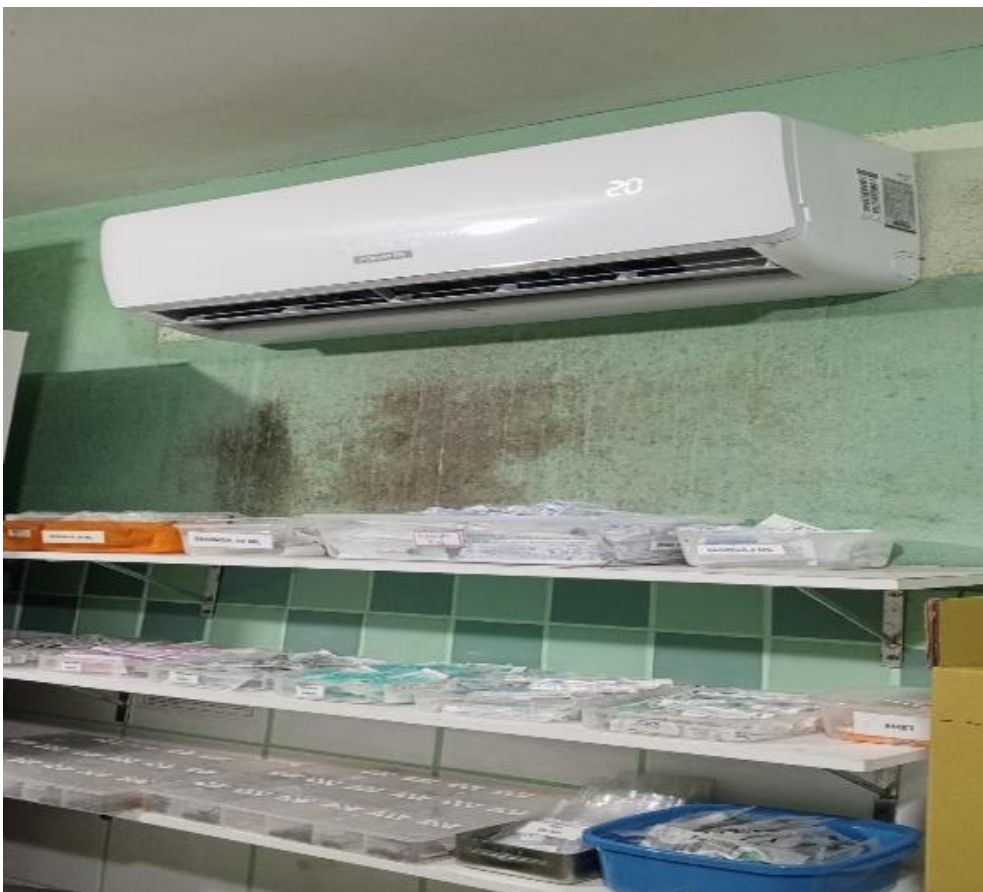
Foto 10 - Parede com mofo na sala de emergência – Vila Valério
