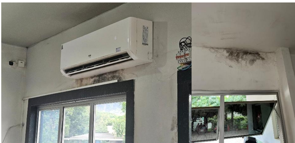
Foto 2 - Fiação exposta e paredes mofadas na recepção - Ibirapu
