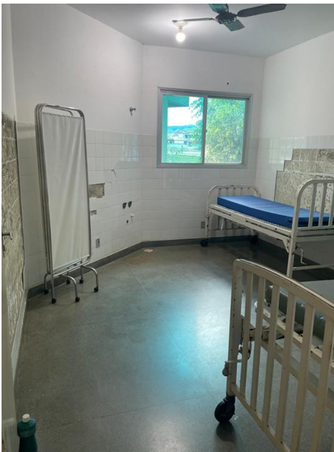
Foto 12 - Paredes da sala de observação sem azulejos – Alto Rio Novo
