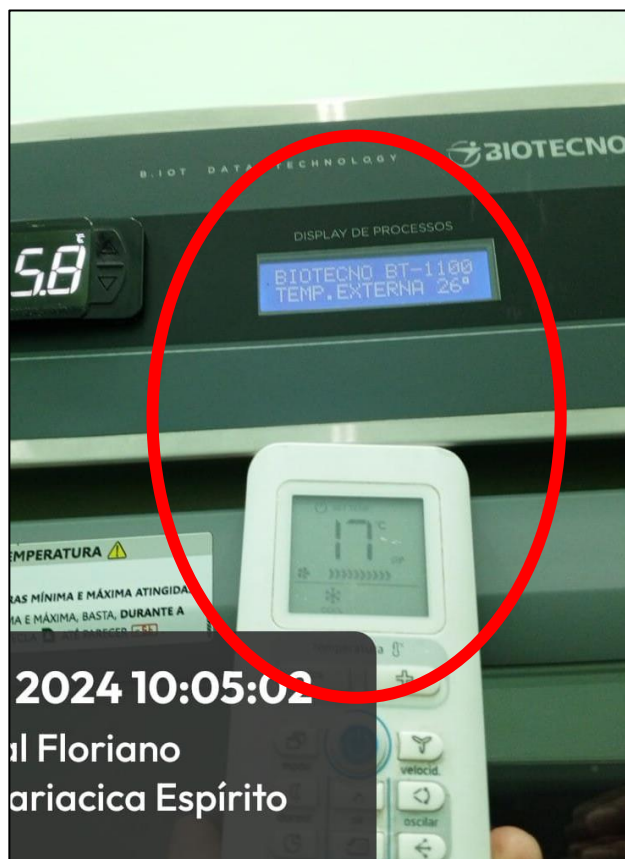
Imagem 12 - Climatização insuficiente da sala de vacinação da UBS Valparaíso (Cariacica)
