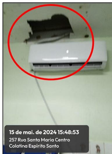
Imagem 20 – Teto quebrado (Sala de vacinação da Policlínica Irmo Antônio Marino - Colatina)
