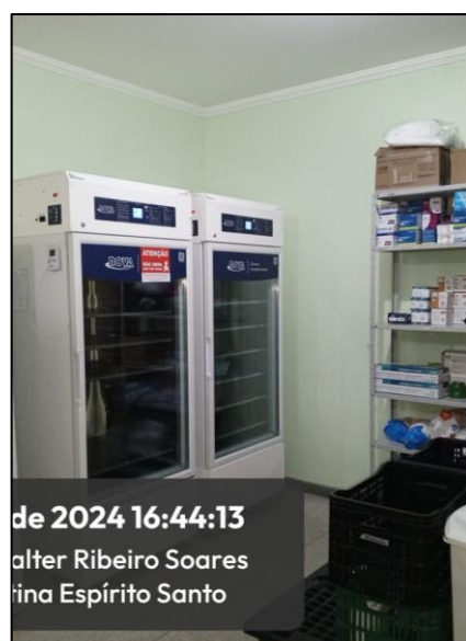
Imagem 22 – Equipamentos quebrados (Central Municipal de Colatina)
