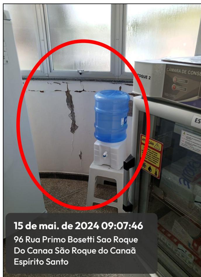
Imagem 2 - Estado de conservação da parede da sala de vacinação de São Roque do Canaã
