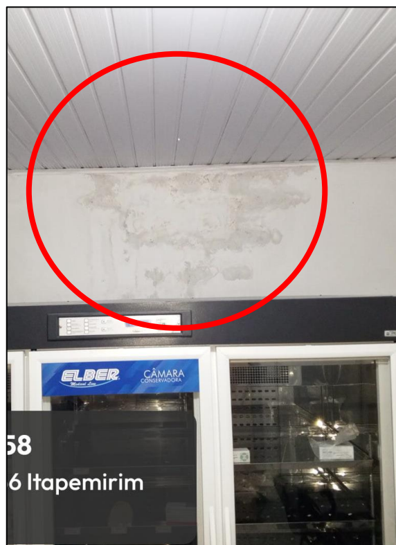
Imagem 16 – Infiltração e mofo na parede (Central Municipal de Itapemirim)
