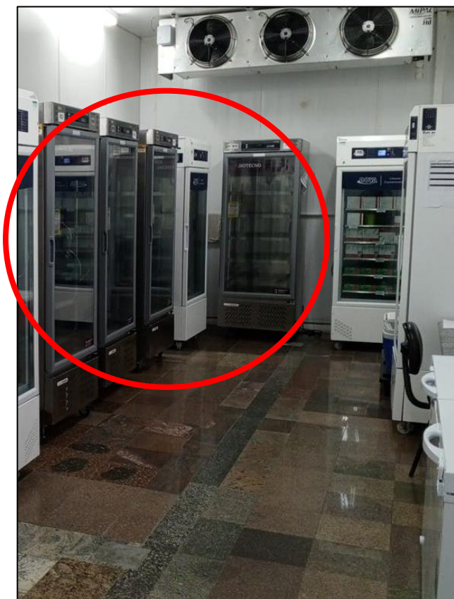
Imagem 11 - Equipamentos quebrados e funcionais sem utilização (Central Municipal de Cariacica)
