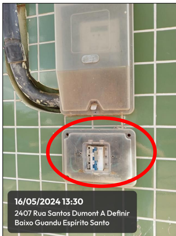
Imagem 10 - Disjuntor exposto em via pública (USF Rosário II, Baixo Guandu)
