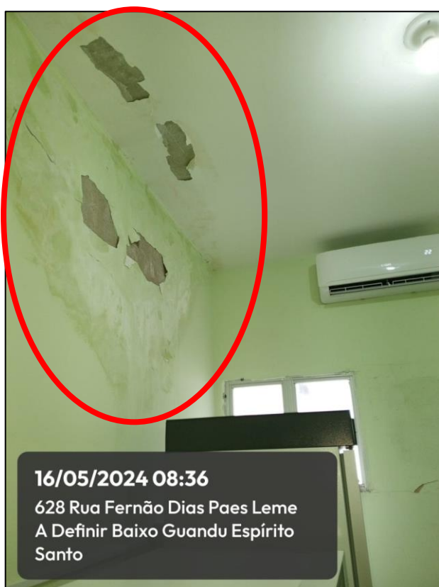
Imagem 9 - Infiltrações e pintura descascada (Central Municipal de Baixo Guandu)
