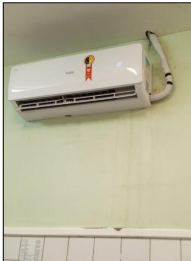
Imagem 26 – Ar-condicionado configurado com temperatura de 22°C (Sala de vacinação da UBS Consolação - Vitória)
