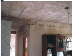
Trincas nas casas
