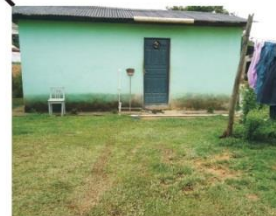
Marca do nível atingido pelas águas
