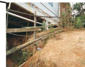
Residência com os alicerces comprometidos
