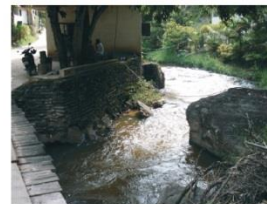
Estreitamento do rio, provocado por construção inadequada
