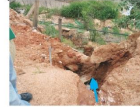
Erosão, proveniente do lançamento de aterro e da falta de drenagem na encosta
