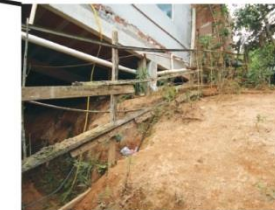
Residência com os alicerces comprometidos
