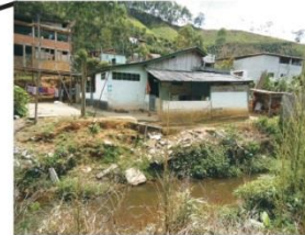
Solapamento da margem do rio
