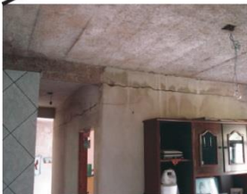
Trincas nas casas
