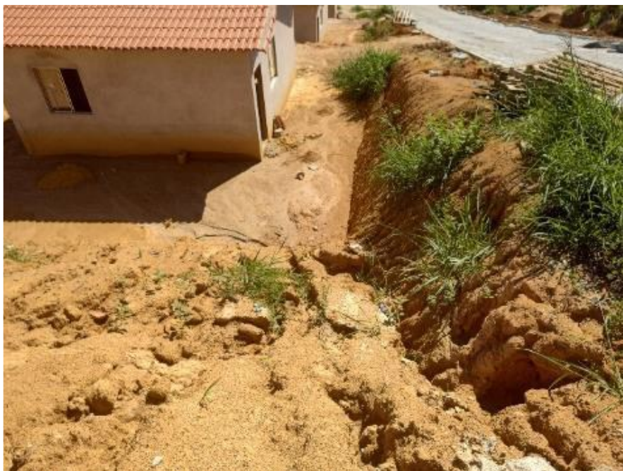
Figura 4 – Talude com erosão, sem tratamento.
