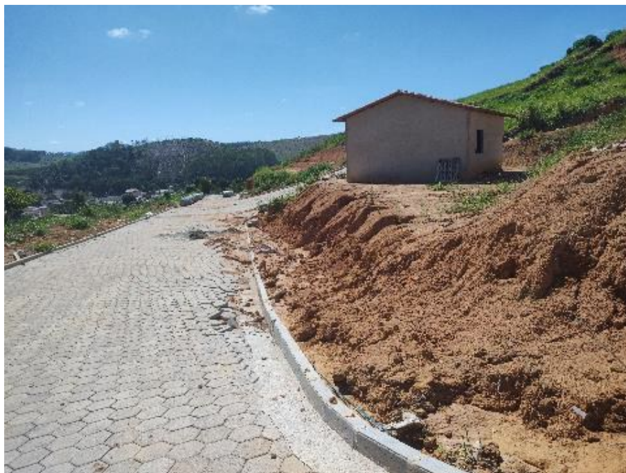
Figura 5 – Erosão acentuada, com sedimentos na via.
