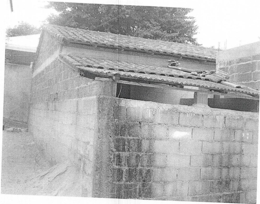
FOTO 04- Vista externa da residência demonstrando o acabamento das paredes e condições do telhado
