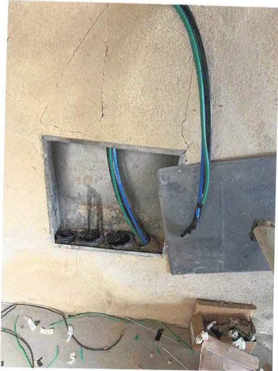
Caixa de passagem
