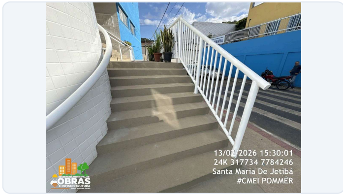
FOTO 15: ITEM 6.0 E 18.22 DA PLANILHA - INSTALAÇÃO E PINTURA DE ESMALTE SINTÉTICO DO GUARDA-CORPO.
