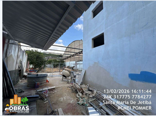
FOTO 22: ITEM 14.2, 18.20 E 18.21 DA PLANILHA - EXECUÇÃO DE COBERTURA COM PERFIS METÁLICOS , TRAMAS DE AÇO E TELHAS DE ALUMINIO TRAPEZOIDAL.
