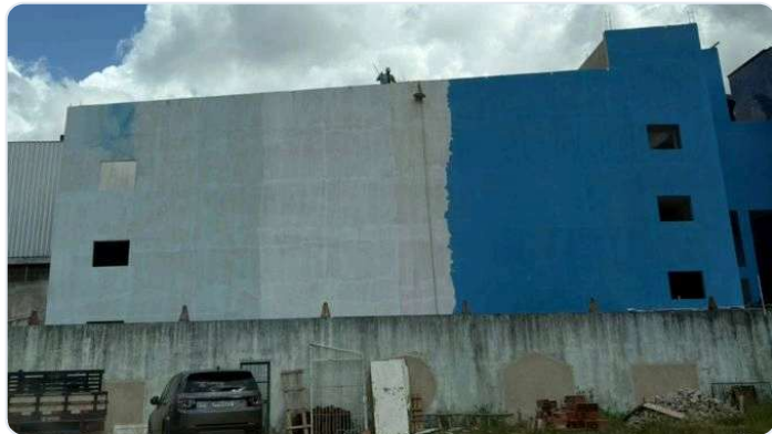
FOTO 65: ITEM 12.0 DA PLANILHA - PINTURA INTERNA E EXTERNA DA ÁREA DA RAMPA NOVA.
