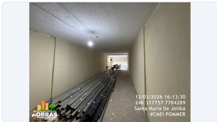
FOTO 55: ITEM 12.0 DA PLANILHA - PINTURA INTERNA E EXTERNA DA ÁREA DA RAMPA NOVA.
