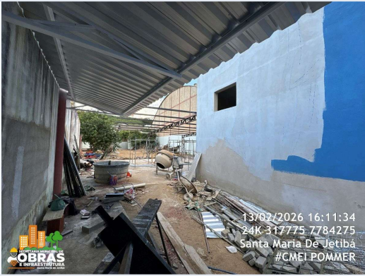
FOTO 21: ITEM 14.2, 18.20 E 18.21 DA PLANILHA - EXECUÇÃO DE COBERTURA COM PERFIS METÁLICOS , TRAMAS DE AÇO E TELHAS DE ALUMINIO TRAPEZOIDAL.
