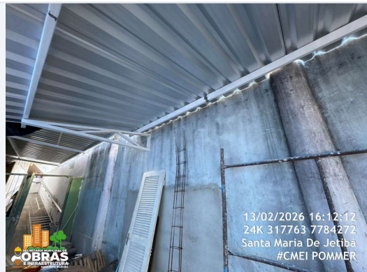
FOTO 26: ITEM 14.2, 18.20 E 18.21 DA PLANILHA - EXECUÇÃO DE COBERTURA COM PERFIS METÁLICOS , TRAMAS DE AÇO E TELHAS DE ALUMINIO TRAPEZOIDAL.
