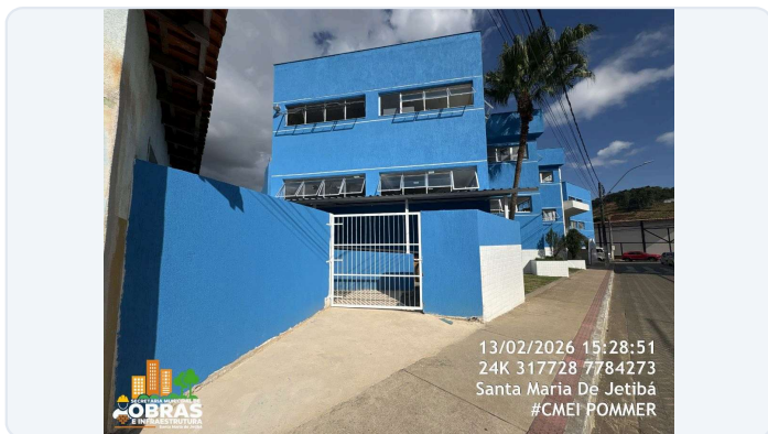
FOTO 13: ITEM 6.0 DA PLANILHA - INSTALAÇÃO E PINTURA DE ESMALTE SINTÉTICO DO ESQUADRIAS METÁLICAS, GRADES E PORTÕES.
