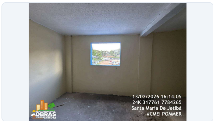
FOTO 61: ITEM 12.0 DA PLANILHA - PINTURA INTERNA E EXTERNA DA ÁREA DA RAMPA NOVA.
