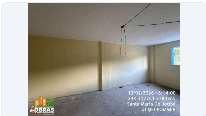
FOTO 59: ITEM 12.0 DA PLANILHA - PINTURA INTERNA E EXTERNA DA ÁREA DA RAMPA NOVA.
