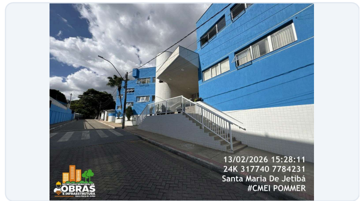
FOTO 12: ITEM 6.0 E 18.22 DA PLANILHA - INSTALAÇÃO E PINTURA DE ESMALTE SINTÉTICO DO GUARDA-CORPO.
