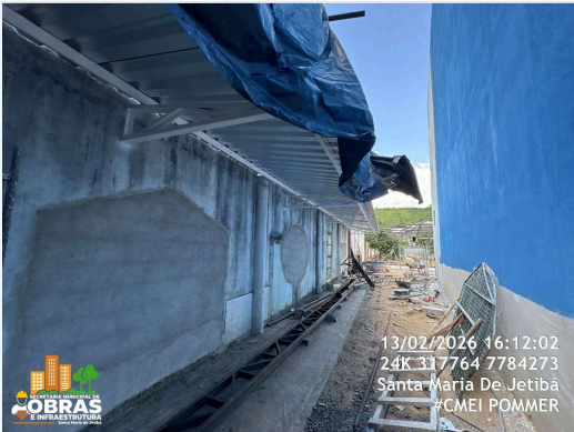
FOTO 23: ITEM 14.2, 18.20 E 18.21 DA PLANILHA - EXECUÇÃO DE COBERTURA COM PERFIS METÁLICOS , TRAMAS DE AÇO E TELHAS DE ALUMINIO TRAPEZOIDAL.
