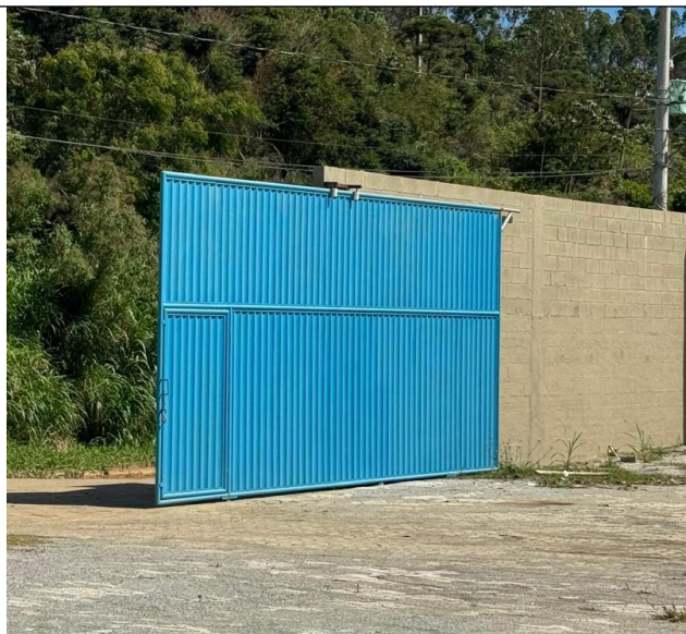
Foto 24 - Portão em chapa de ferro
