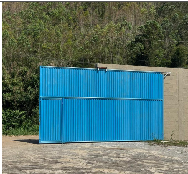
Foto 23 - Portão em chapa de ferro
