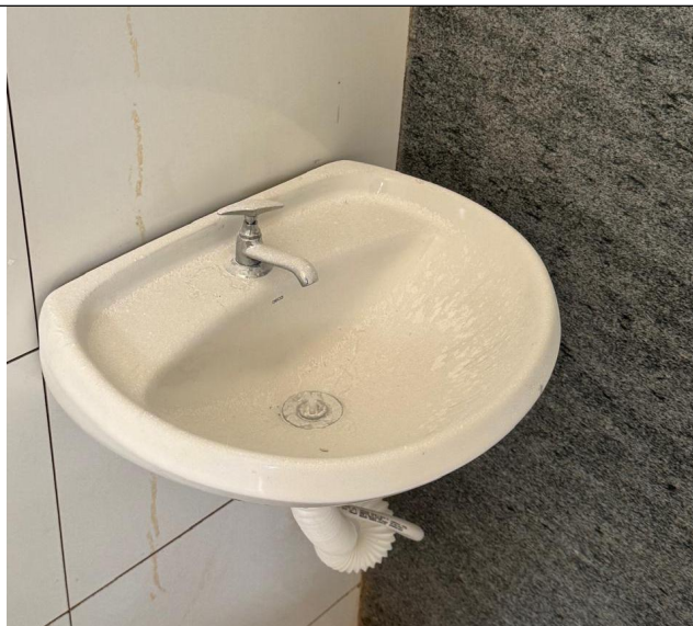
Foto 10 - Torneira cromada / Lavatório de louça branca
