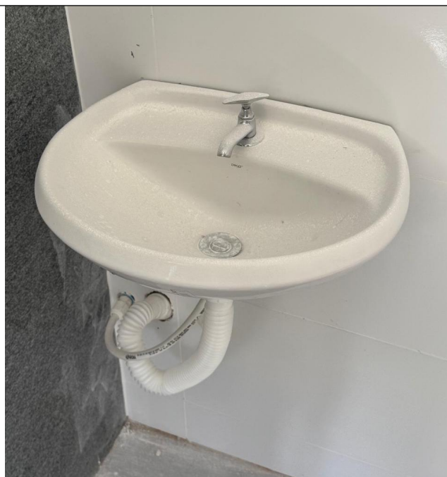
Foto 12 - Torneira cromada / Lavatório de louça branca
