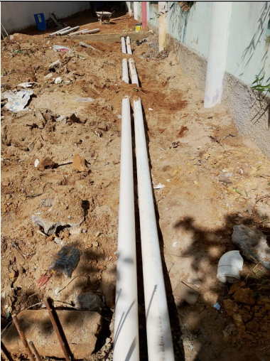
Foto 53: Instalações para drenagem de águas pluviais e manutenção da rede de esgoto
