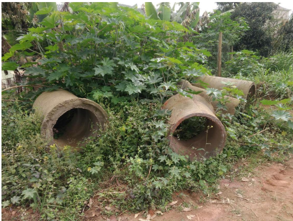
Manilhas no pátio da Sub-Prefeitura - Pedacos quebrados - Vegetação crescendo.
