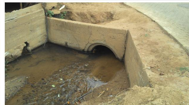
Figura 6-24: Bueiro avariado e assoreado na Rua Ribeiro Limpo no Bairro Vila Nova, em Santa Leopoldina-ES.
