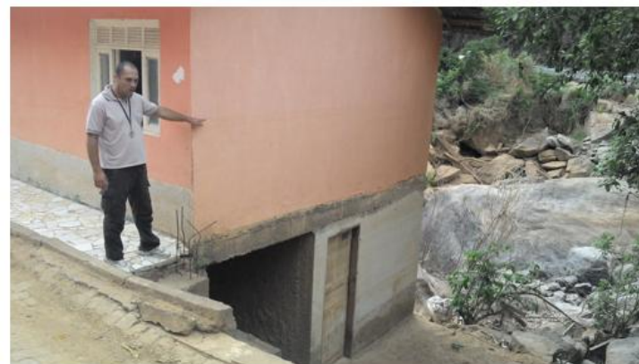
Figura 6-17: Marca d'água da última inundação (dezembro de 2013) em edificação a montante
