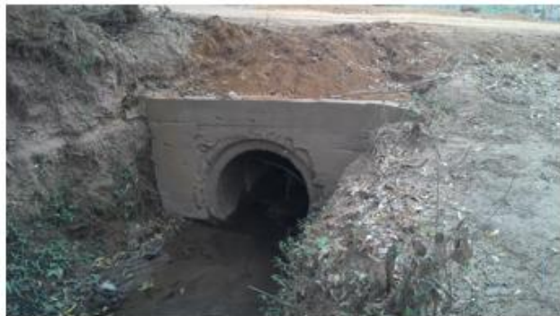
Figura 6-22: Bueiro instalado no córrego do Nove próximo à sua foz no Rio Santa Maria da Vitória.
