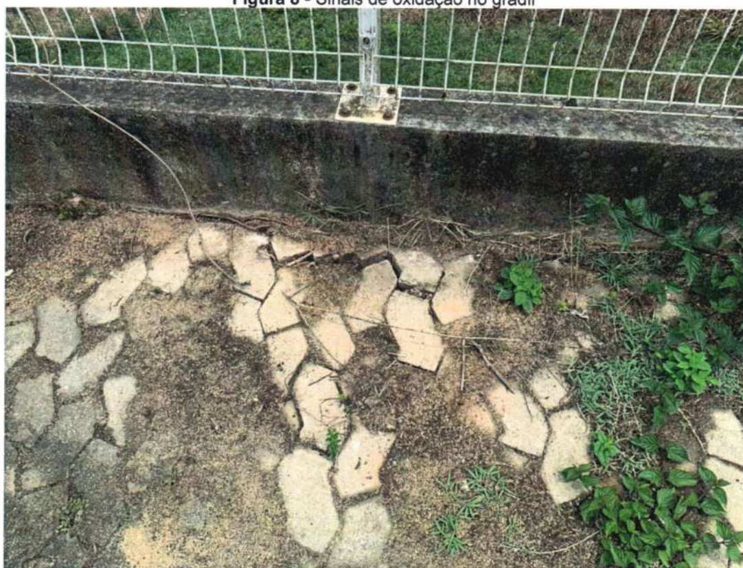
Figura 9 - Piso intertravado com rachadura devido a possível recalque e afundamentos.
