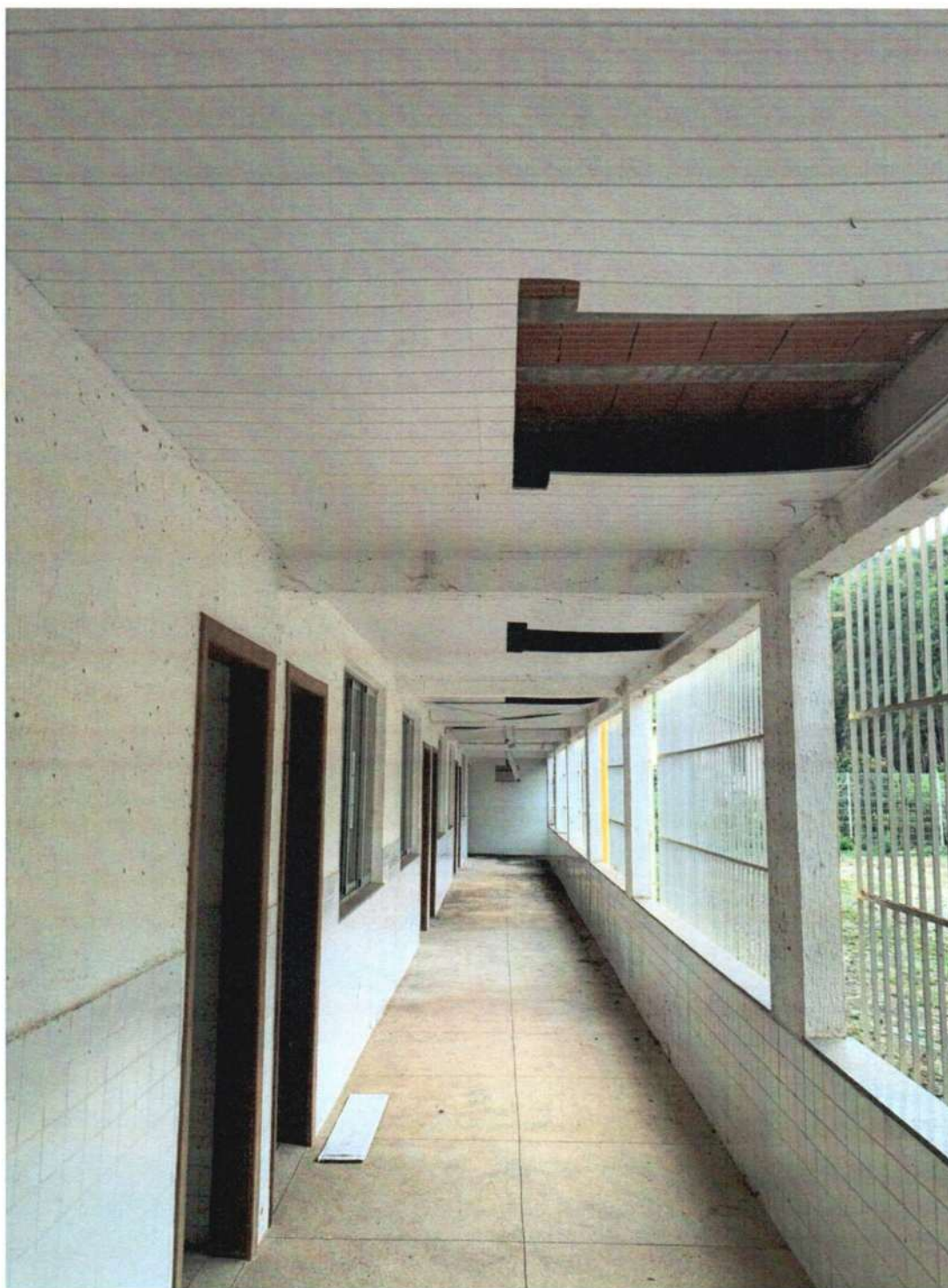
Figura 144 - Corredor do térreo, sobre cada uma das vigas, identificação rachaduras, trincas ou fissuras.
