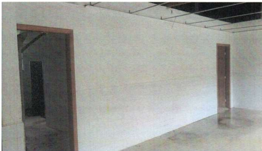
Figura 145 - Porta dos banheiros masculino e feminino, com alisares e marcos conservados, vazamento no telhada devido a furos e quebras nas telhas.
