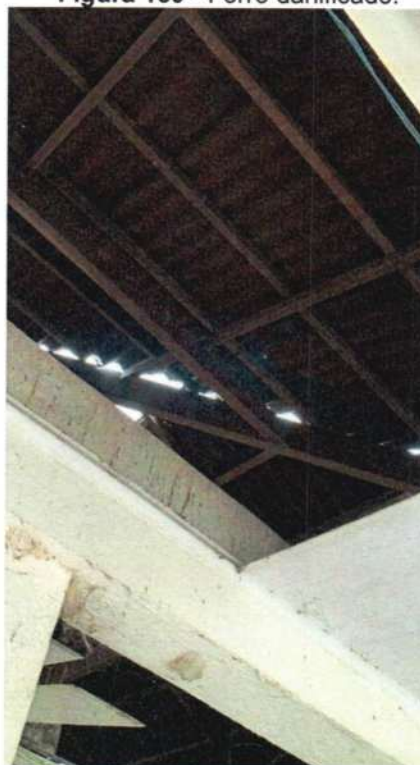
Figura 160 - Aberturas nas telhas, proporcionando vazamentos.
