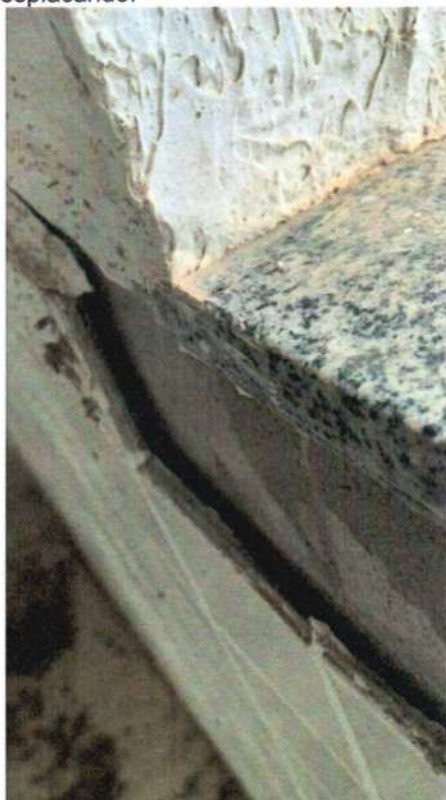
Figura 162 - Revestimento das paredes estufado.
