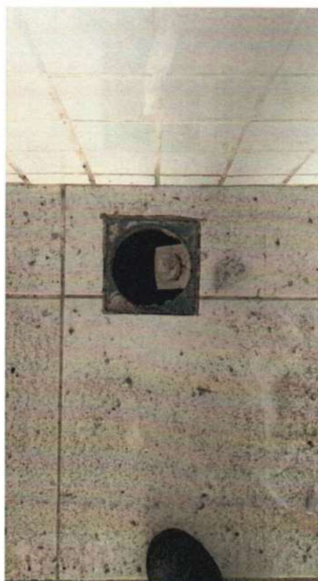
Figura 36 - Sifão sem tampa
