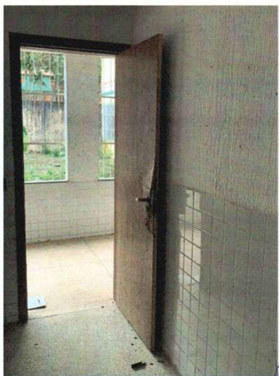
Figura 54 - Porta danificada, ainda com fechadura e maçaneta.
