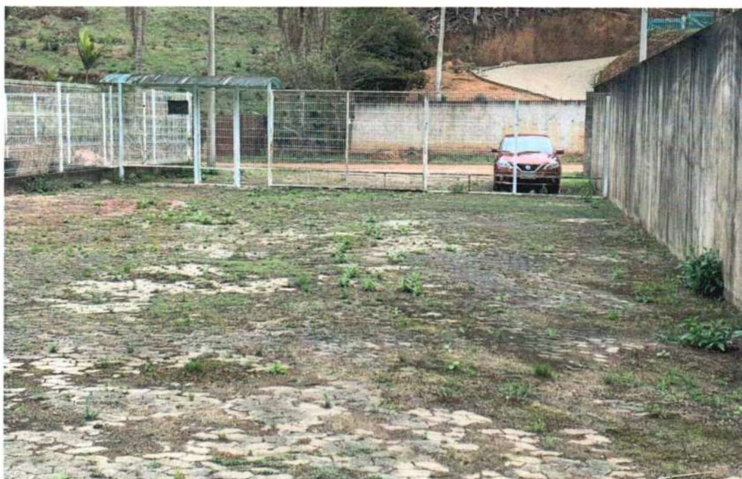
Figura 6 - Pátio interior da escola com crescimento de vegetação e afundamentos no piso intertravado.
