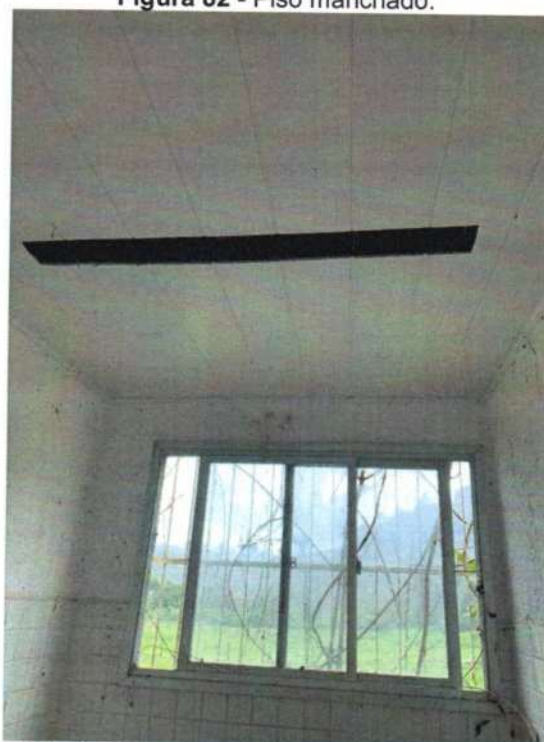
Figura 83 - Forro de PVC e esquadria conservados, mas sem luminária
