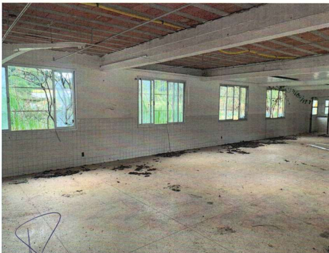
Figura 16 - Esquadrias funcionando, teto sem forro de PVC.
