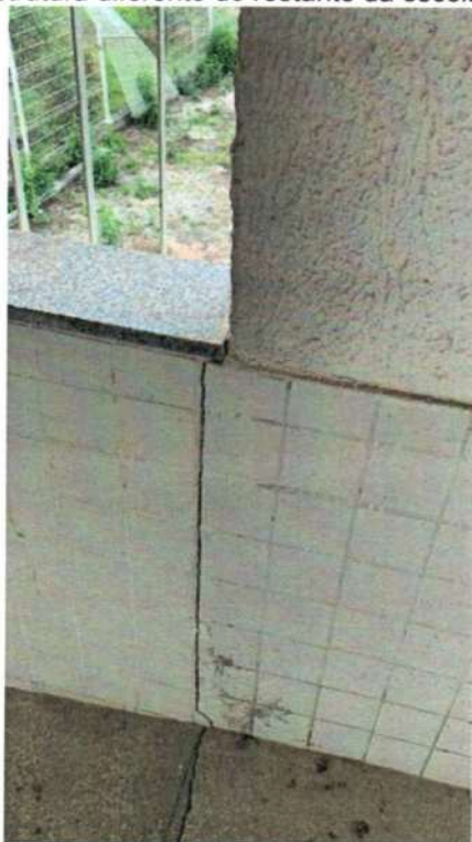
Figura 158 - Rachadura na divisa das estruturas
