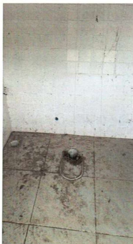
Figura 179 - Ausência de louças e metais.
