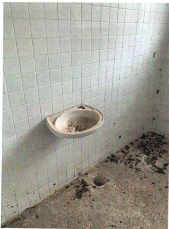
Figura 88 - Revestimento das paredes conservado, porém com exceção da pia, louças e metais foram retirados.
