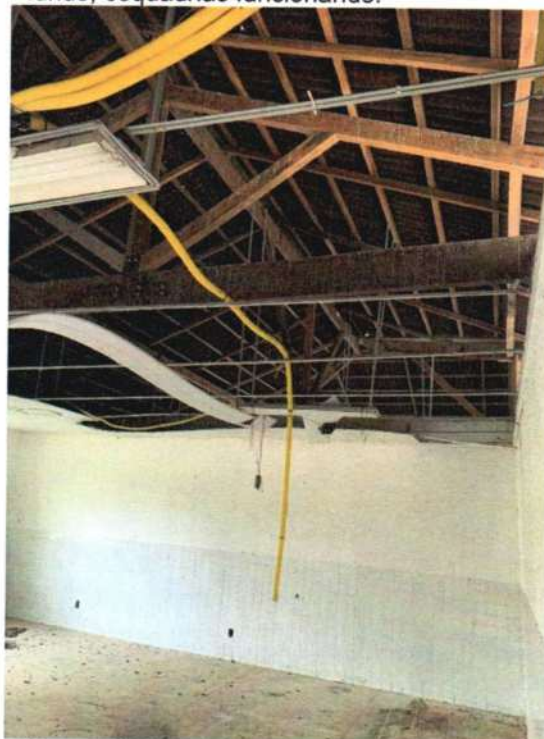
Figura 111 - Madeiramento da cobertura conservado, mas telhas furadas e quebradas.
