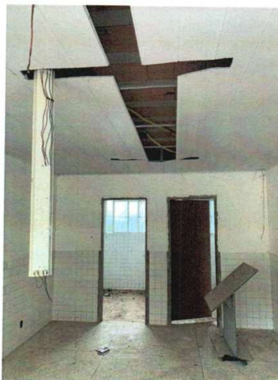
Figura 79 - Forro de PVC e luminárias danificadas ao fundo banheiros anexos.
