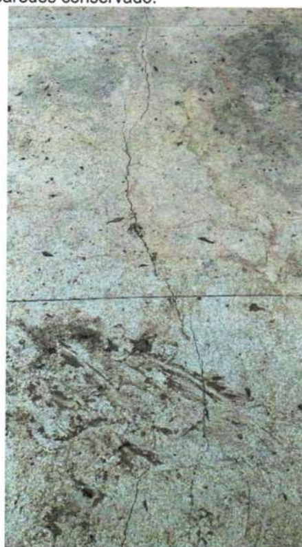
Figura 131 - Rachadura em cima do apoio da viga inferior, percorrendo toda a sala
