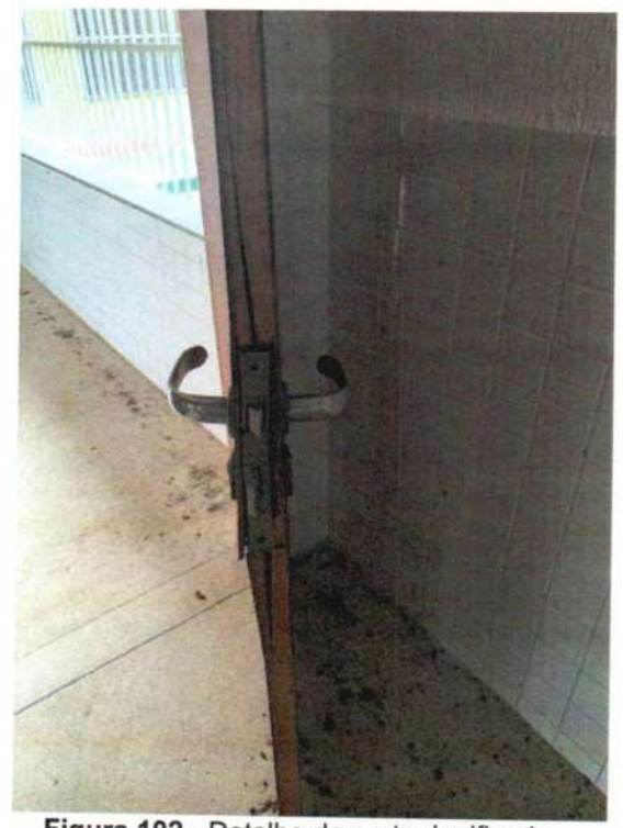
Figura 102 - Detalhe da porta danificada.
