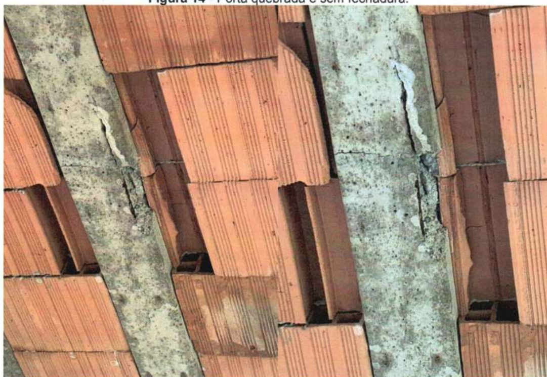
Figura 15 - Laje pré-moldada avariada
