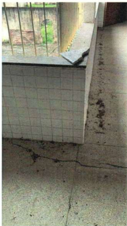
Figura 138 - Rachadura sobre viga inferior
