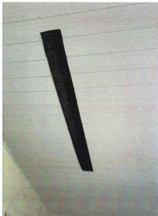
Figura 74 - Forro de PVC conservado, luminária ausente.
