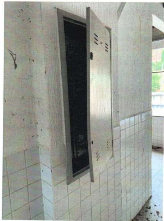
Figura 93 - Quadro de distribuição de energia vazio.
