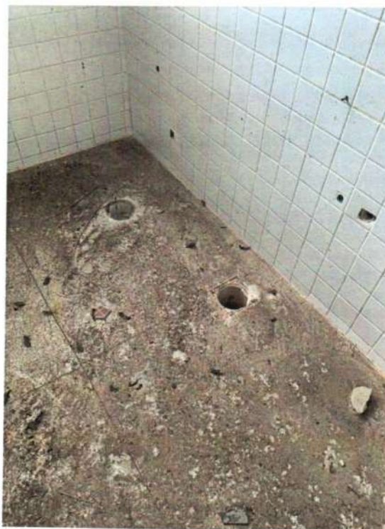
Figura 89 - Revestimento das paredes conservado, porém, louças e metais foram retirados.
