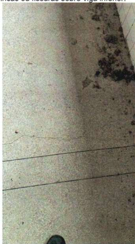
Figura 143 - Padrão repetitivo: rachaduras, trincas ou fissuras sobre viga inferior.
