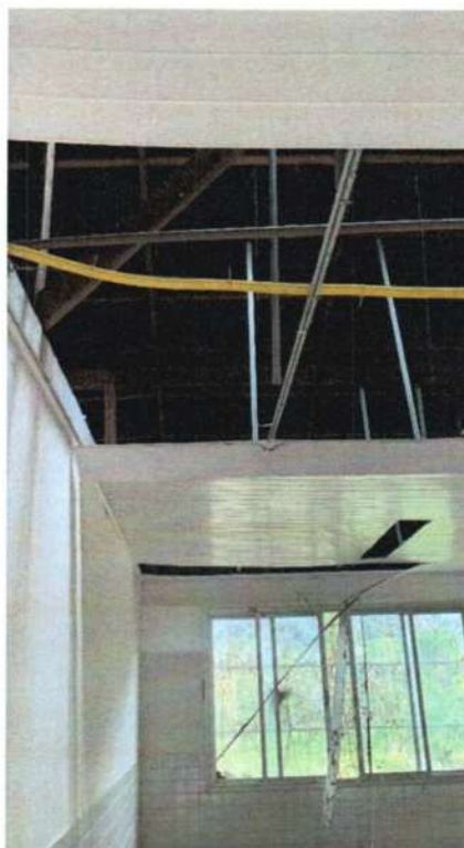
Figura 134 - Forro de PVC danificado.
