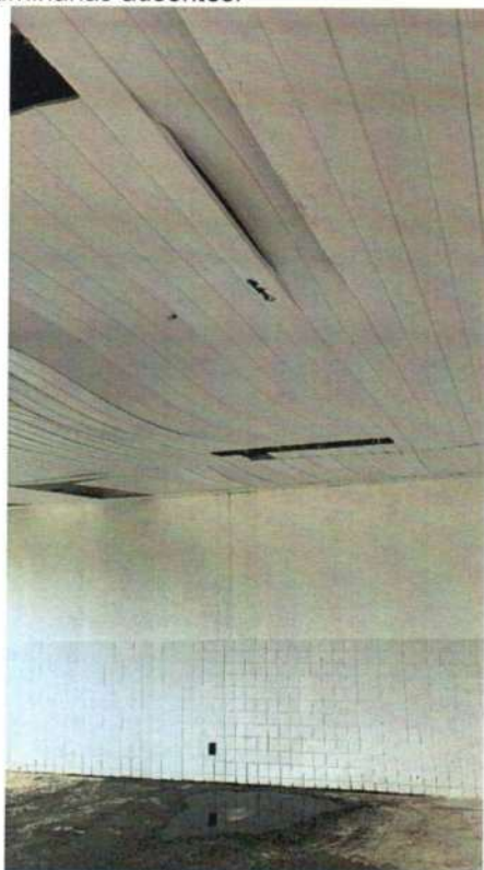
Figura 129 - Forro de PVC danificado e vazamento pelo telhado.
