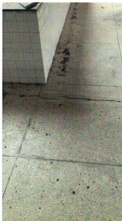
Figura 139 - Rachadura sobre viga inferior
