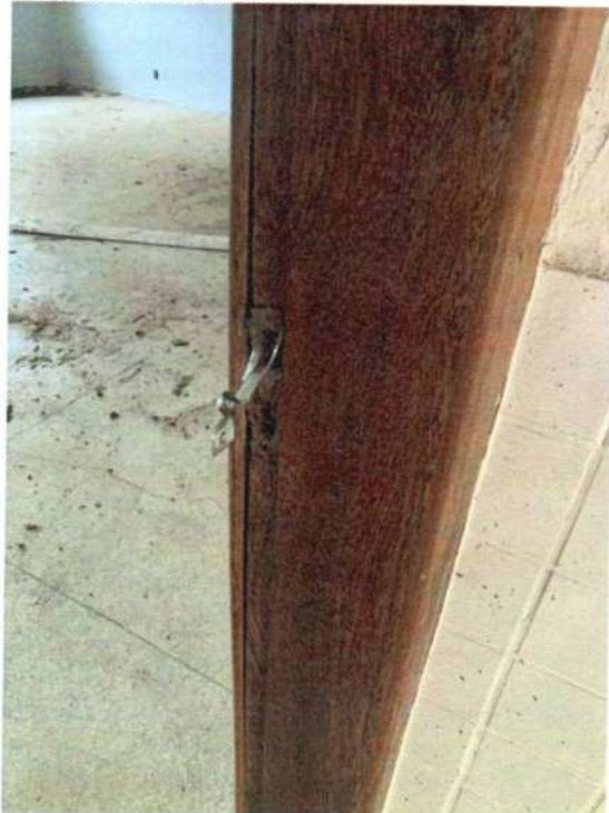
Figura 117 - Espelho da fechadura danificado.
