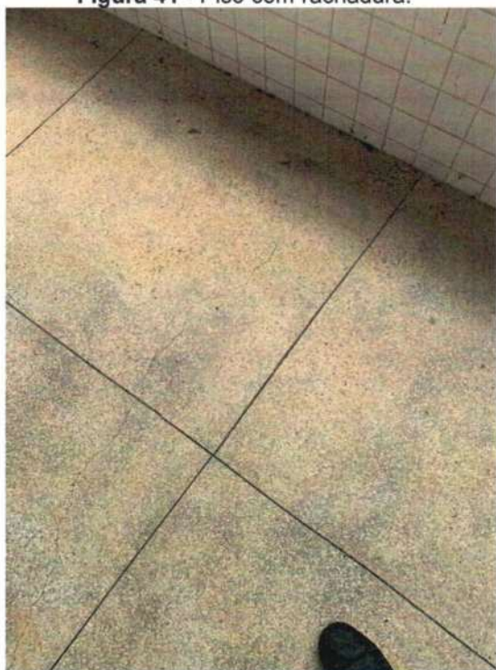
Figura 42 - Identificação de fissuras no piso.
