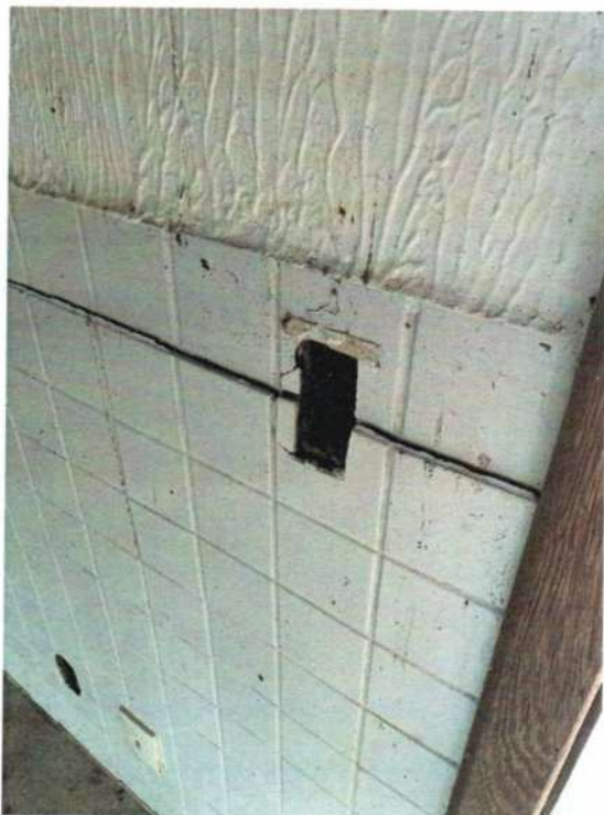
Figura 109 - Revestimento interno de paredes com deslocamento.
