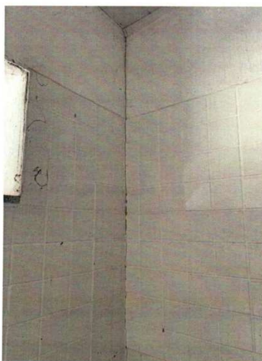
Figura 98 - indicativo de descolamento da alvenaria na junção entre as paredes.
