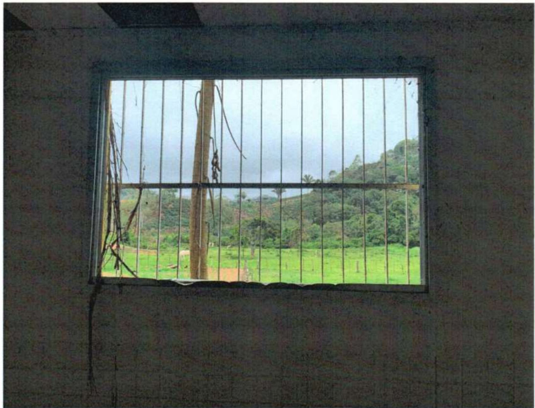
Figura 53 - Vão sem esquadria, com caixilho danificado.
