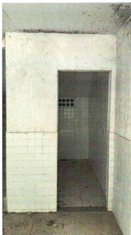
Figura 32 - vão de entrada sem porta.
