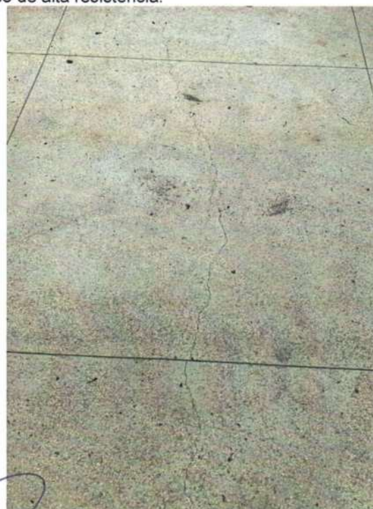
Figura 60 - Piso de alta resistência com trincas.
