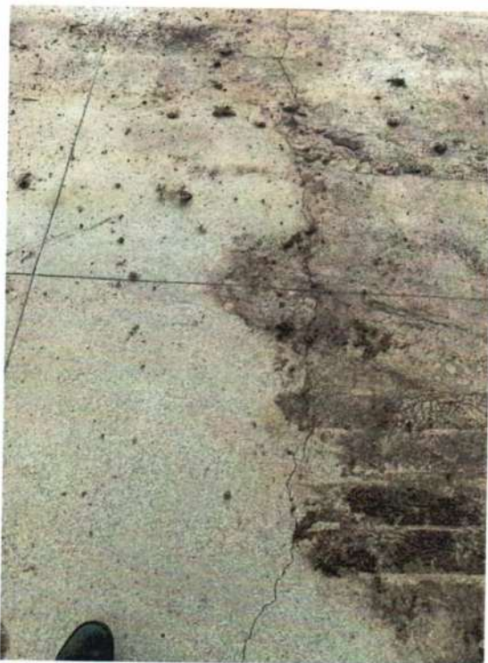
Figura 113 - Rachadura no piso de alta resistência de uma ponta a outra da sala
