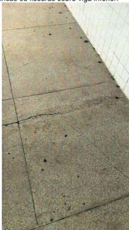
Figura 141 - Padrão repetitivo: rachaduras, trincas ou fissuras sobre viga inferior.
