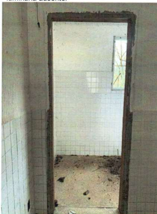
Figura 75 - Vão da porta de banheiro anexo sem alisares.
