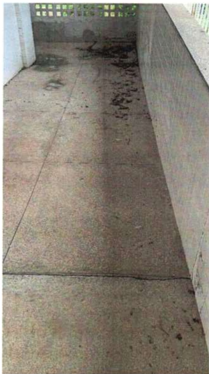
Figura 157 - Rachadura no início da rampa, estrutura diferente do restante da escola.
