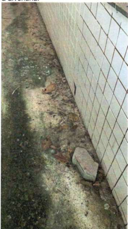
Figura 170 - Desplacamento de revestimentos das paredes.
