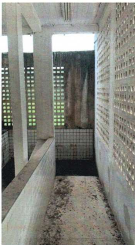
Figura 165 - Falta de vedação entre a laje e a parede proporciona infiltrações.
