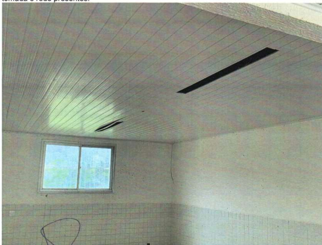
Figura 57 - Teto com forro de PVC, mas sem luminárias.
