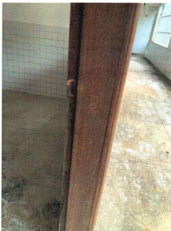
Figura 65 - Marco da porta danificado.
