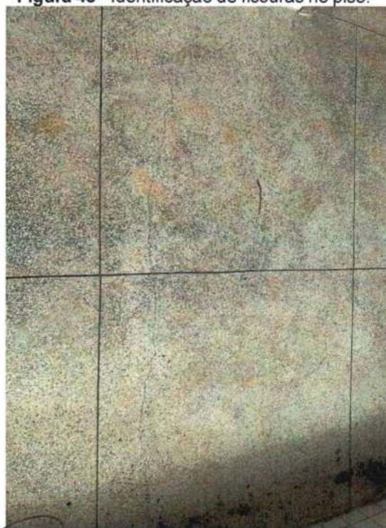
Figura 44 - Identificação de fissuras no piso.
