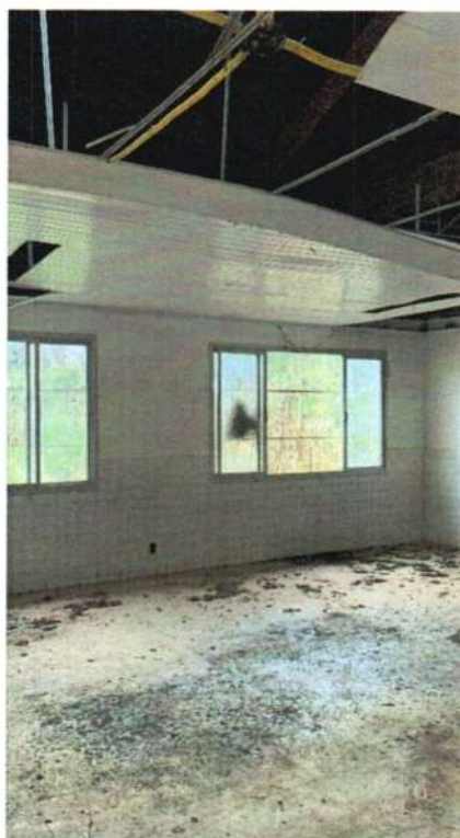
Figura 135 - Madeiramento do telhado conservado, telhas furadas e quebradas.
