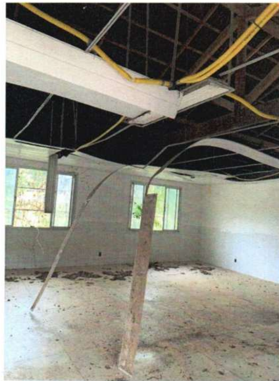
Figura 110 - Forro de PVC danificado, ao fundo, esquadrias funcionando.
