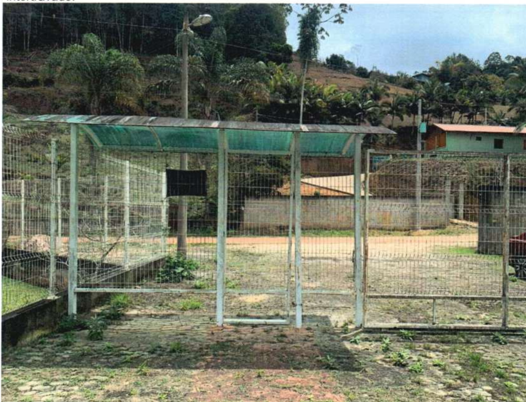
Figura 7 - Portão de gradil Nylofor com avarias.
