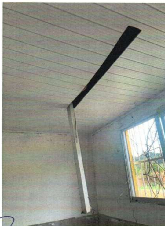
Figura 28 - Luminária presente, mas sem lâmpadas, forro de PVC conservado.
