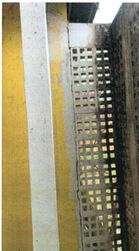
Figura 169 - Descolamento entre o cobogó e a alvenaria.
