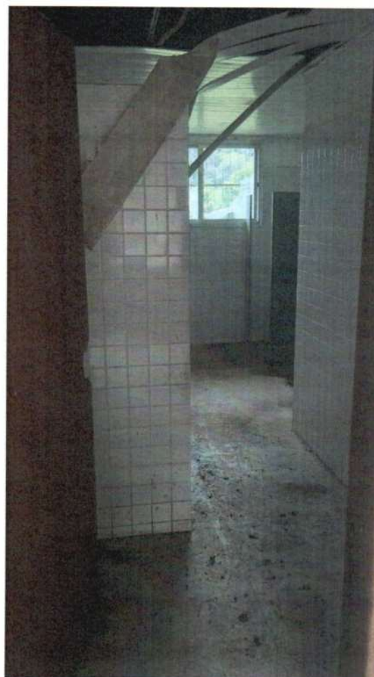
Figura 155 - Forro de PVC danificado.
