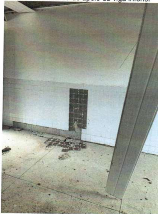
Figura 115 - Revestimento interno das paredes descolado.
