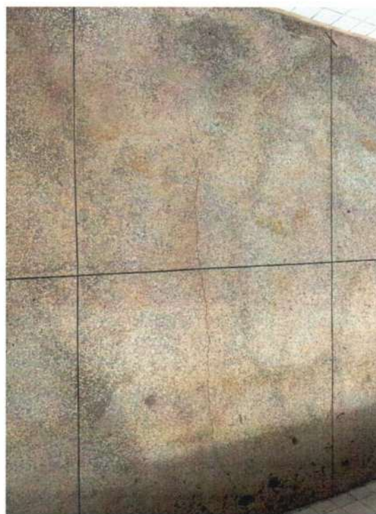
Figura 43 - Identificação de fissuras no piso.
