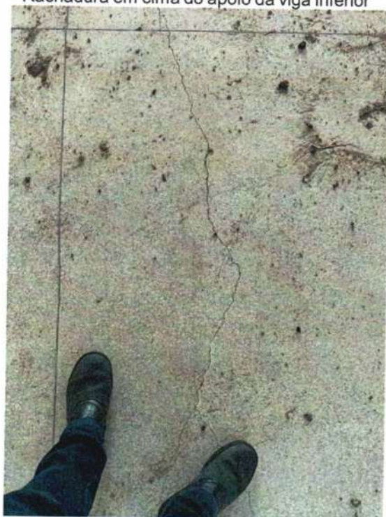
Figura 121 - Rachadura no piso de alta resistência de uma ponta a outra da sala. Rachadura em cima do apoio da viga inferior
