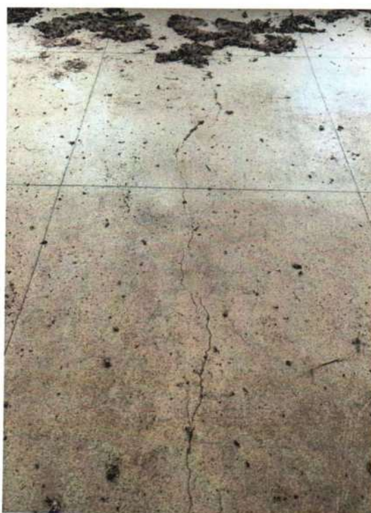
Figura 114 - Rachadura no piso de alta resistência de uma ponta a outra da sala. Rachadura em cima do apoio da viga inferior
