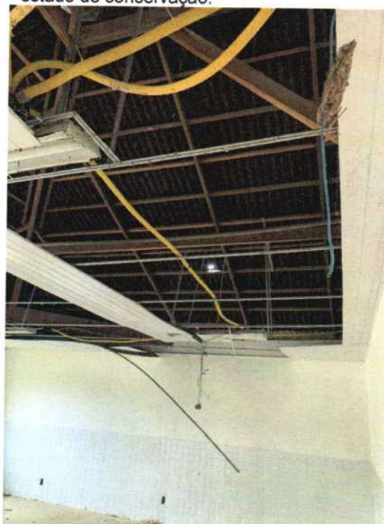
Figura 119 - Forro de PVC danificado, madeiramento do telhado conservado e telhas com furos e quebradas.
