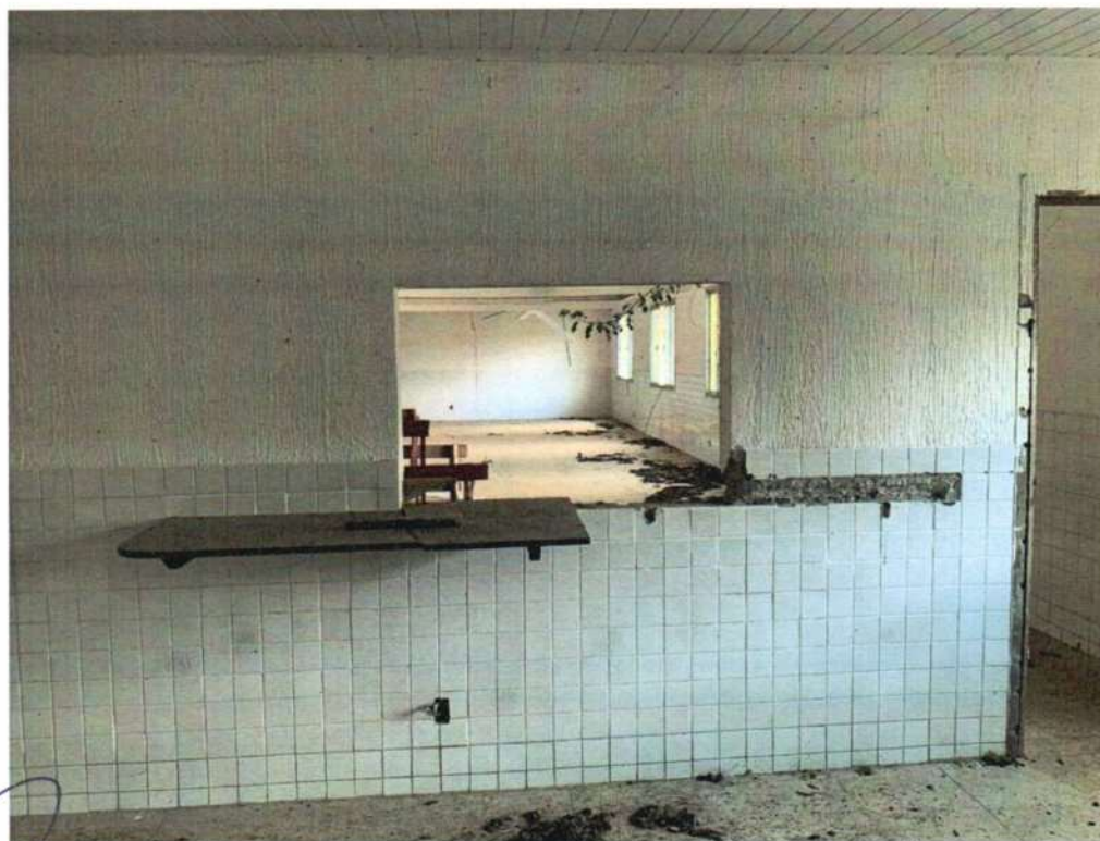
Figura 19 - Bancada da cozinha quebrada, vão sem porta e alisares.
