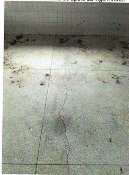
Figura 123 - Rachadura no piso de alta resistência de uma ponta a outra da sala. Rachadura em cima do apoio da viga inferior
