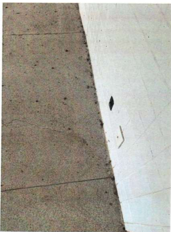
Figura 120 - Rachadura no piso de alta resistência de uma ponta a outra da sala. Rachadura em cima do apoio da viga inferior
