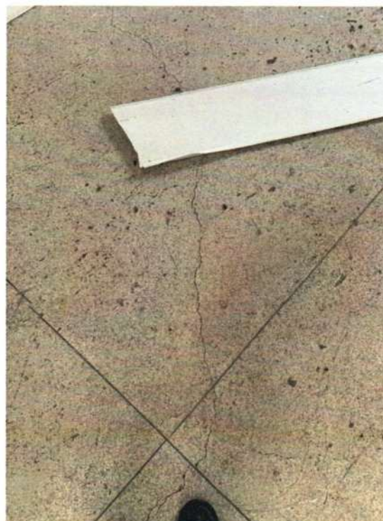
Figura 51 - Detalhe das trincas.
