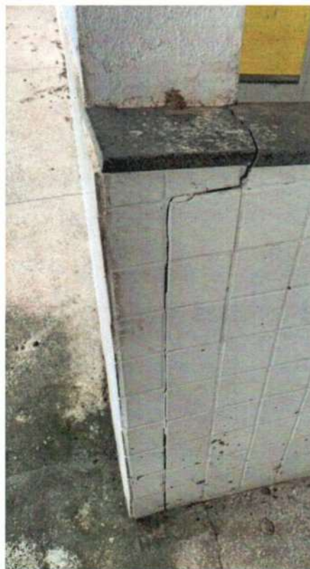
Figura 163 - Rachadura em paredes e peitoril
