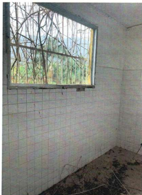
Figura 77 - Caixilho de esquadria de banheiro anexo danificada.
