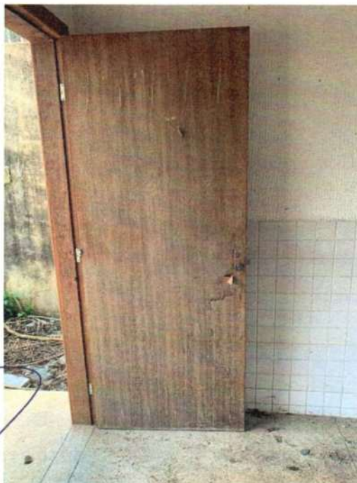
Figura 14 - Porta quebrada e sem fechadura.
