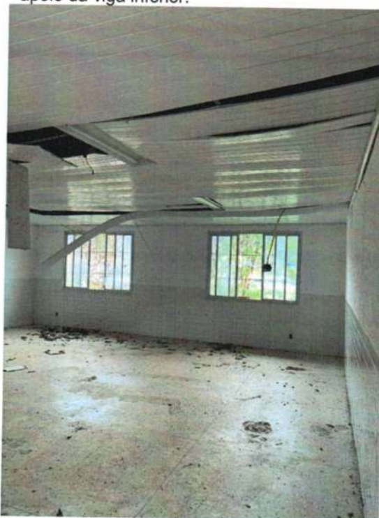
Figura 107 - Esquadrias em funcionamento, forrode PVC avariado e luminárias existentes.
