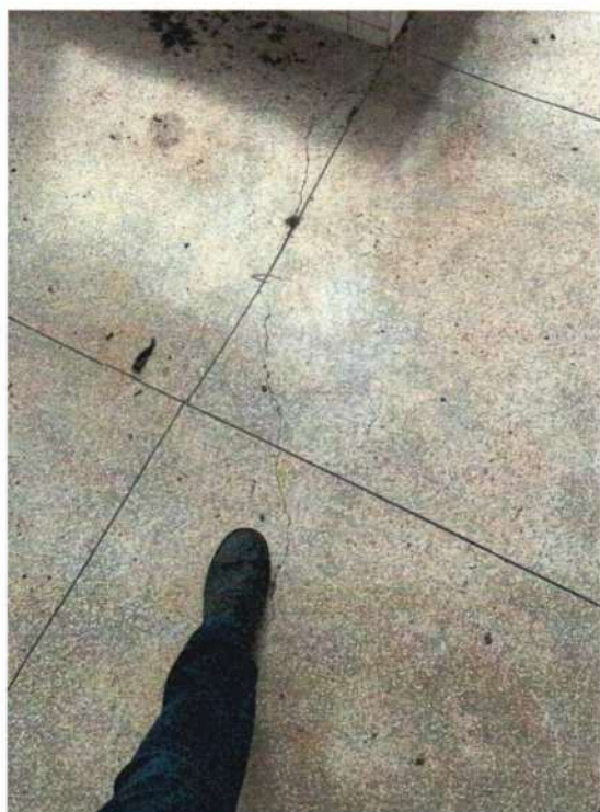
Figura 41 - Piso com rachadura.
