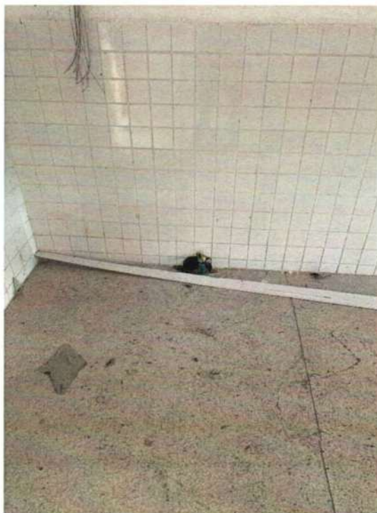
Figura 49 - Piso com trincas significativas.
