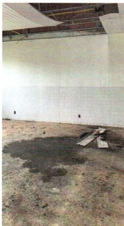
Figura 137 - Piso sujo, com indicativo de vazamento no telhado.
