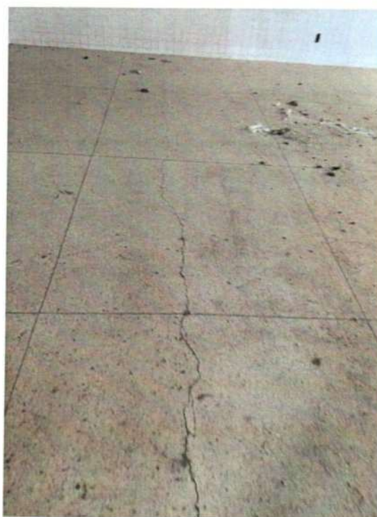
Figura 106 - Rachadura se em cima do apoio da viga inferior.
