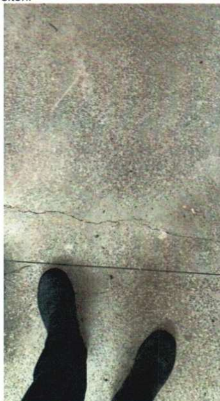
Figura 164 - Trinca no piso de alta resistência.
