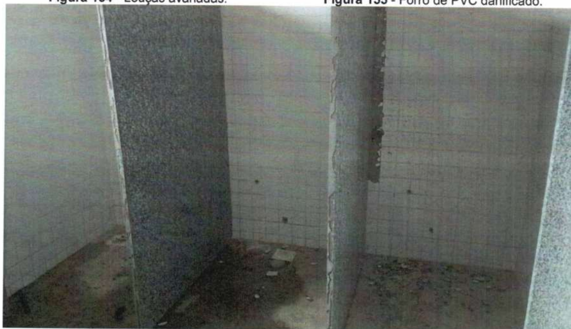
Figura 156 - Revestimento das paredes entre divisórias danificado.
