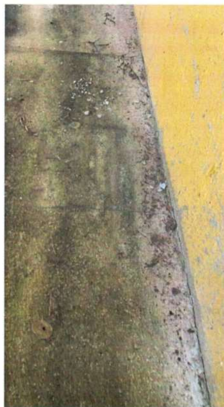
Figura 171 - Rachadura entre piso e parede.
