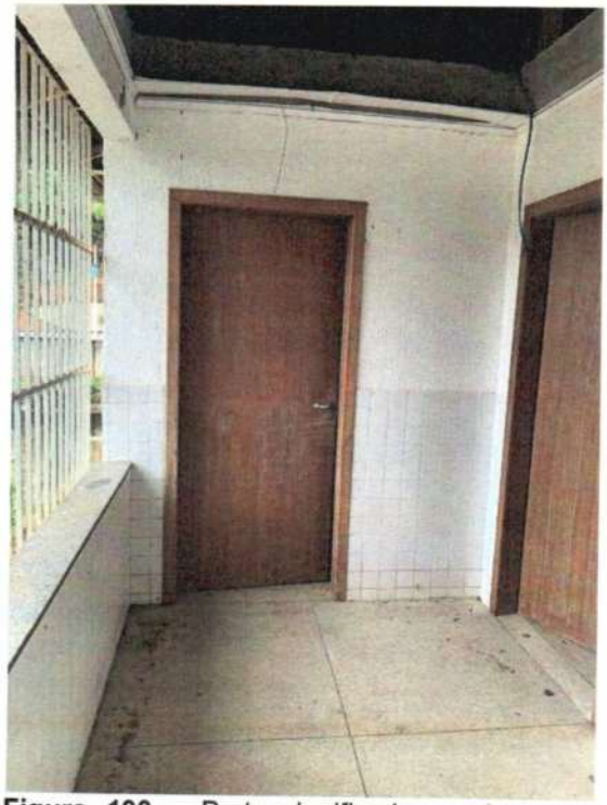
Figura 100 - Porta danificada, porém com alisares externos e marco conservados.
