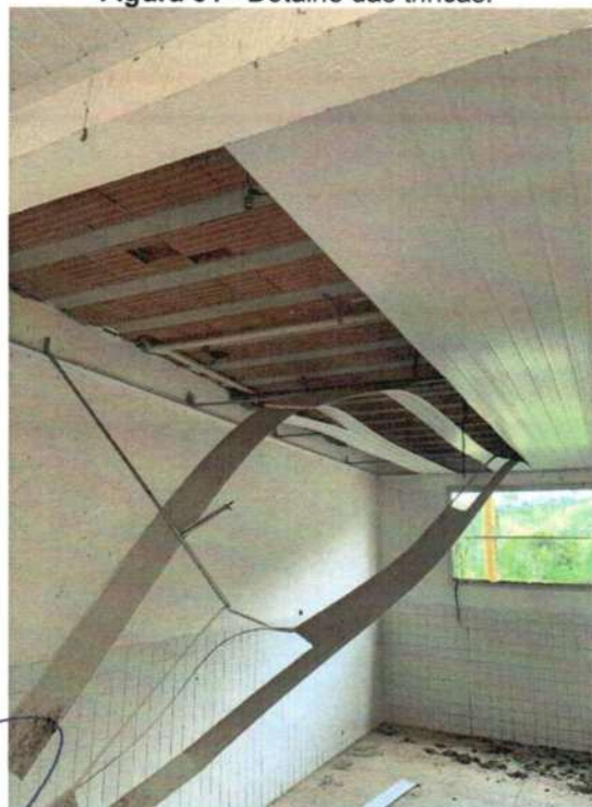
Figura 52 - Forro de PVC danificado.
