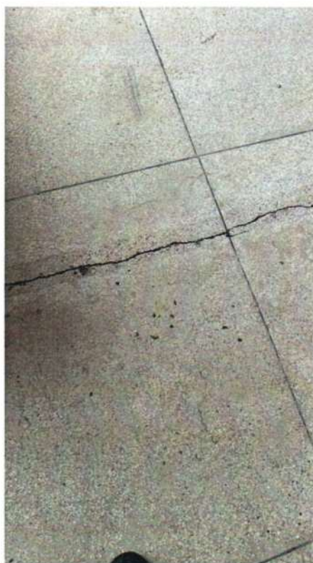
Figura 140 - Padrão repetitivo: rachaduras, trincas ou fissuras sobre viga inferior.
