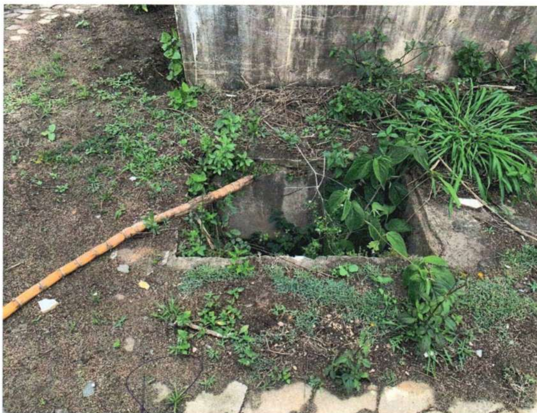
Figura 12 - caixa de inspeção sem tampa.
