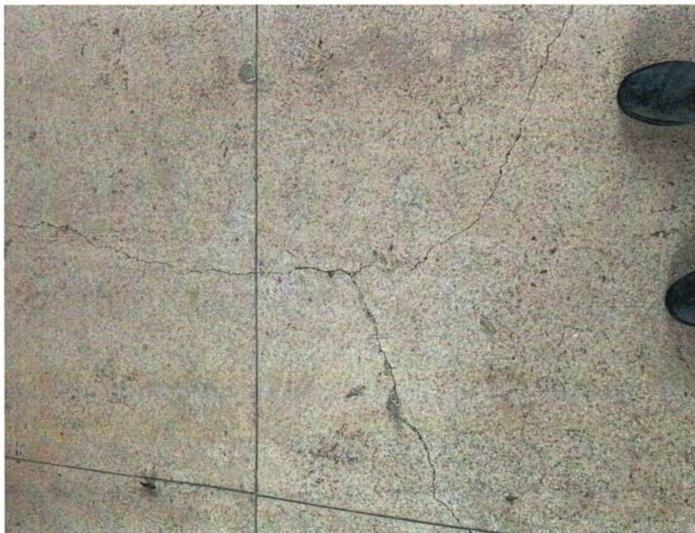
Figura 18 - piso apresenta rachaduras de até 2mm de espessura.
