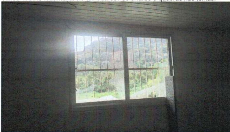
Figura 146 - Esquadria com vidro quebrado e dificuldade de funcionamento.
