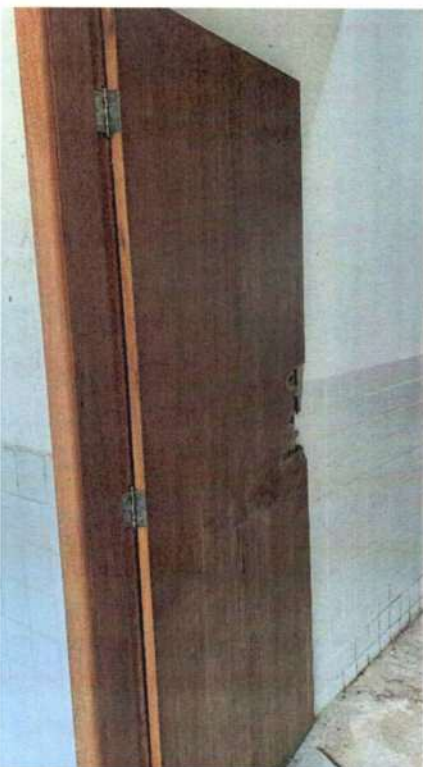
Figura 132 - Porta danificada, sem maçaneta e fechadura, marco e alisares conservados.
