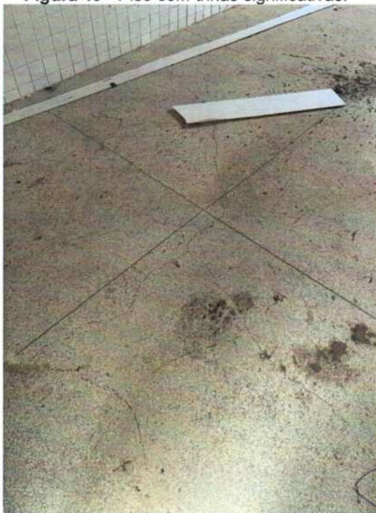
Figura 50 - Detalhes das trincas.
