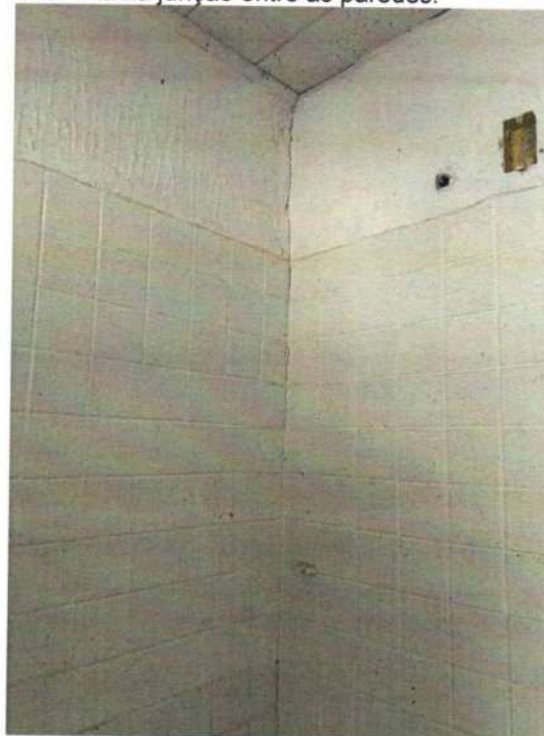
Figura 99 - Falta de chuveiro.
