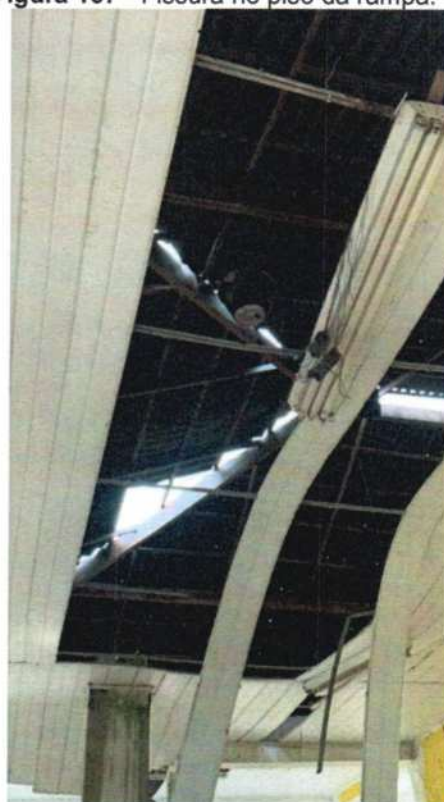
Figura 168 - Ausência de telhas proporcionando vazamento.
