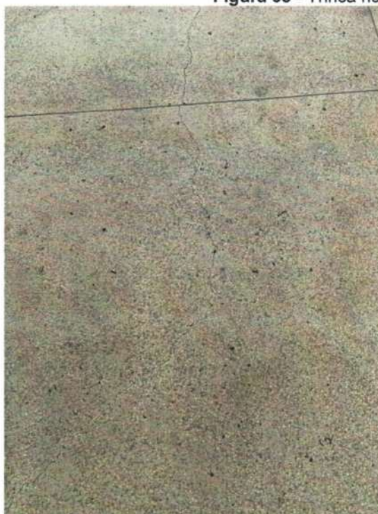
Figura 59 - Piso de alta resistência com trincas.
