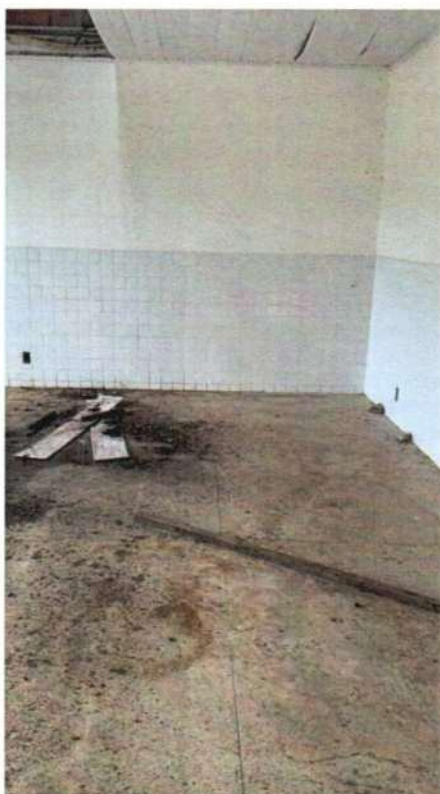
Figura 136 - Piso sujo, com indicativos de vazamento no telhado.
