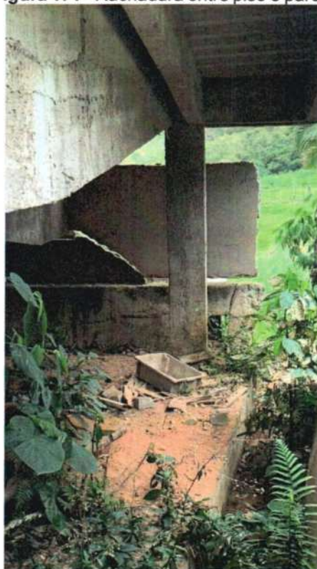
Figura 172 - Vida de sustentação danificada.
