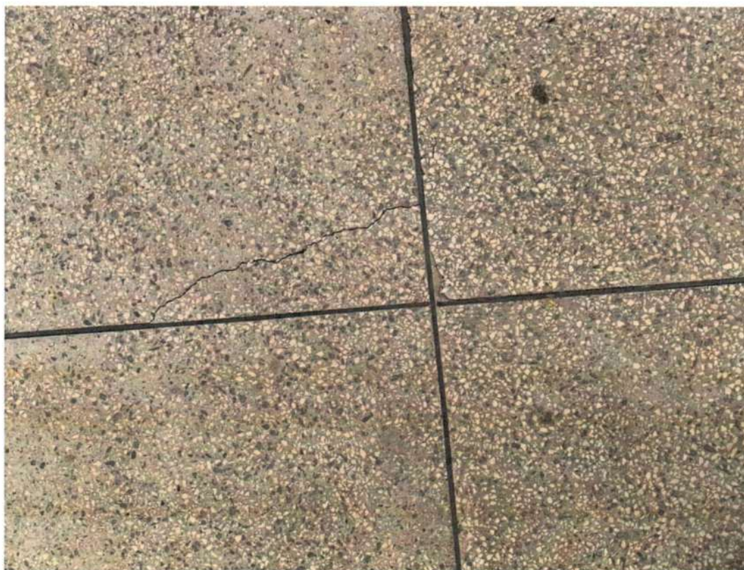
Figura 58 - Trinca no piso de alta resistência.
