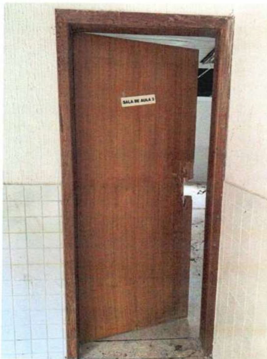
Figura 116 - Porta danificada, mas alisares e marco, conservados.
