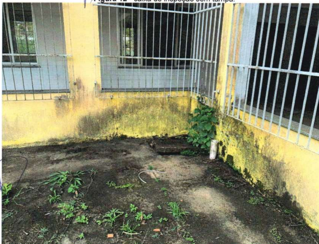
Figura 13 - Caixa de inspeção com tampa deslocada e pintura externa deficiente.
