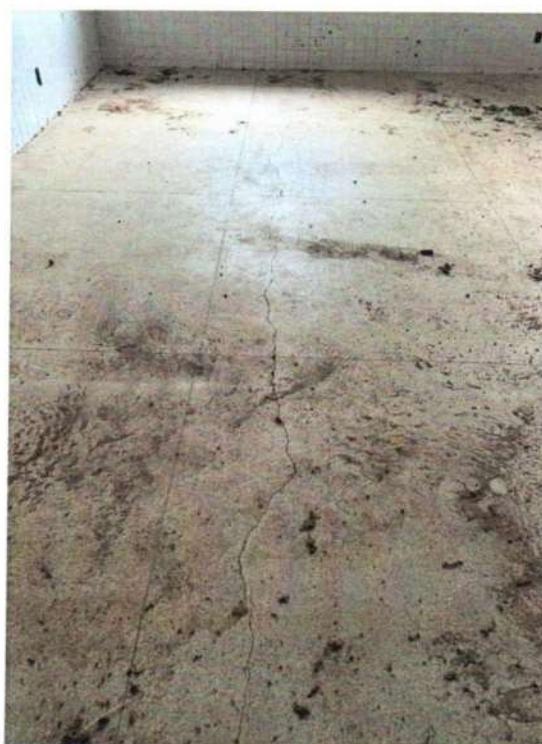
Figura 122 - Rachadura no piso de alta resistência de uma ponta a outra da sala. Rachadura em cima do apoio da viga inferior
