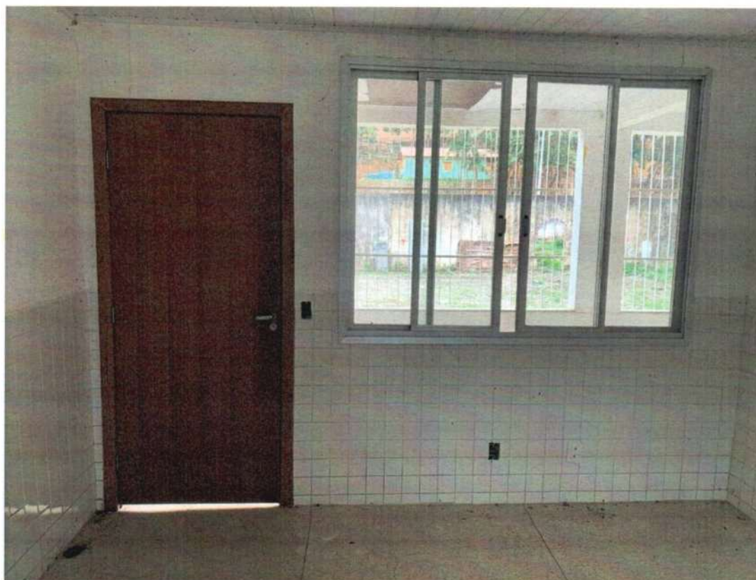
Figura 61 - Sala em melhor estado de conservação, com porta e esquadria conservadas.
