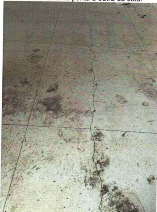
Figura 105 - - Rachadura no piso de alta resistência de uma ponta a outra da sala. Rachadura em cima do apoio da viga inferior.
