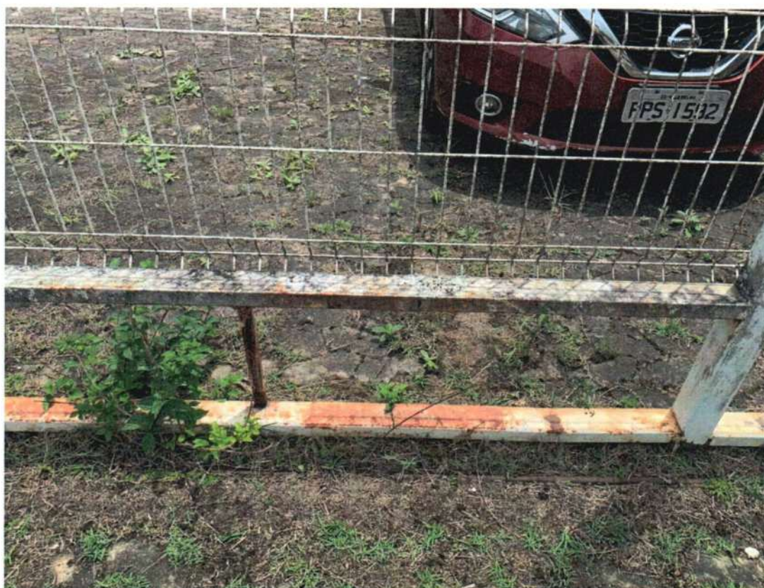
Figura 8 - Sinais de oxidação no gradil
