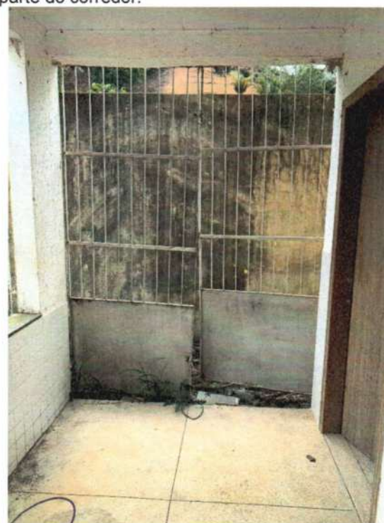
Figura 40 - Portão de acesso ao corredor, precisa de reparos.
