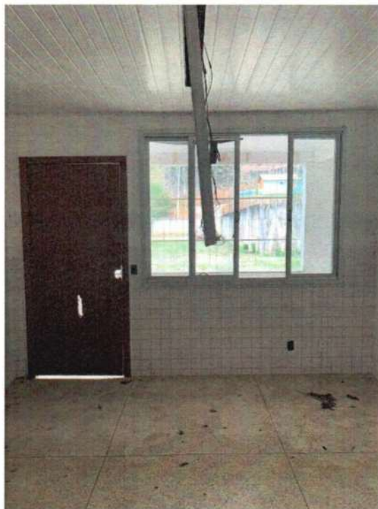
Figura 72 - Porta danificada, marco e alisares conservados, bem como esquadria.
