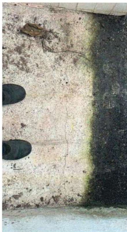
Figura 167 - Fissura no piso da rampa.
