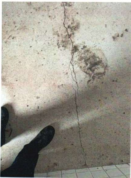
Figura 104 - Rachadura no piso de alta resistência de uma ponta a outra da sala.
