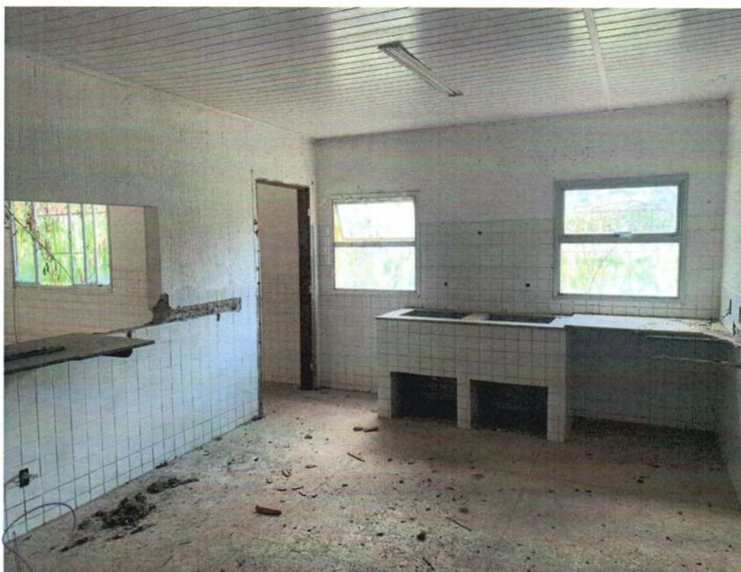
Figura 20 - Bancadas quebradas, pia sem metais, piso sujo e esquadrias funcionando.
