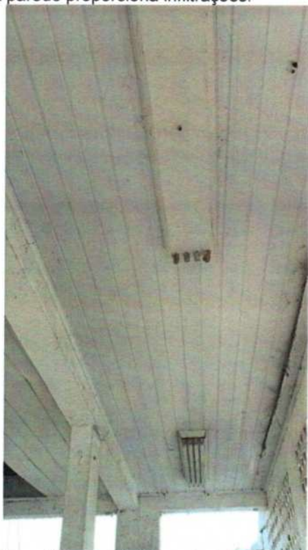
Figura 166 - Luminárias e forro conservados em alguns locais.
