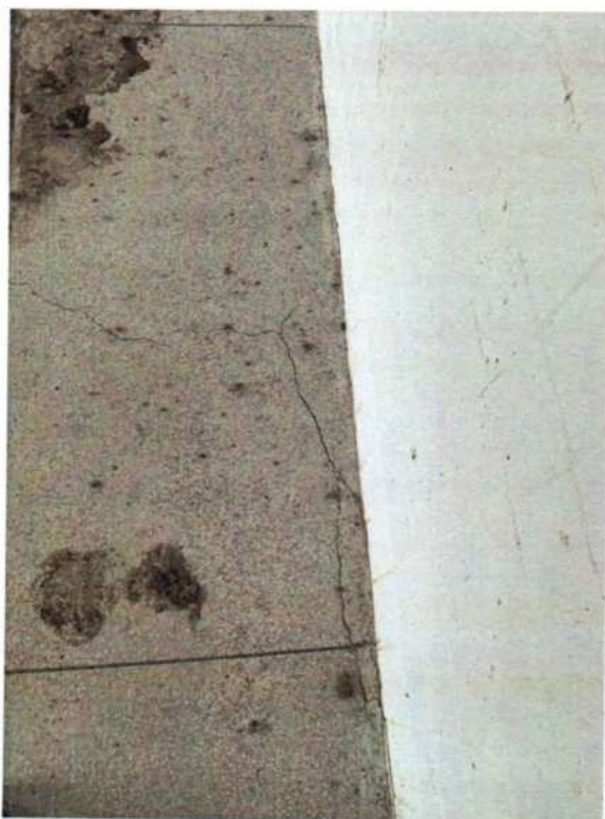
Figura 112 - Rachadura em piso próxima a parede.
