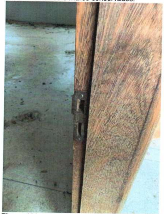
Figura 101 - espelho da fechadura danificado.
