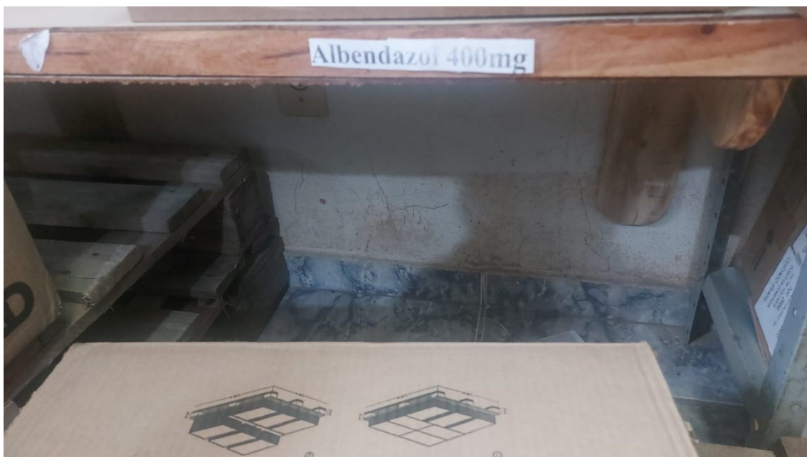
Foto 16 – parede deteriorada na farmácia municipal de São José do Calçado. Fonte: Elaboração própria, em 18/12/2024.
