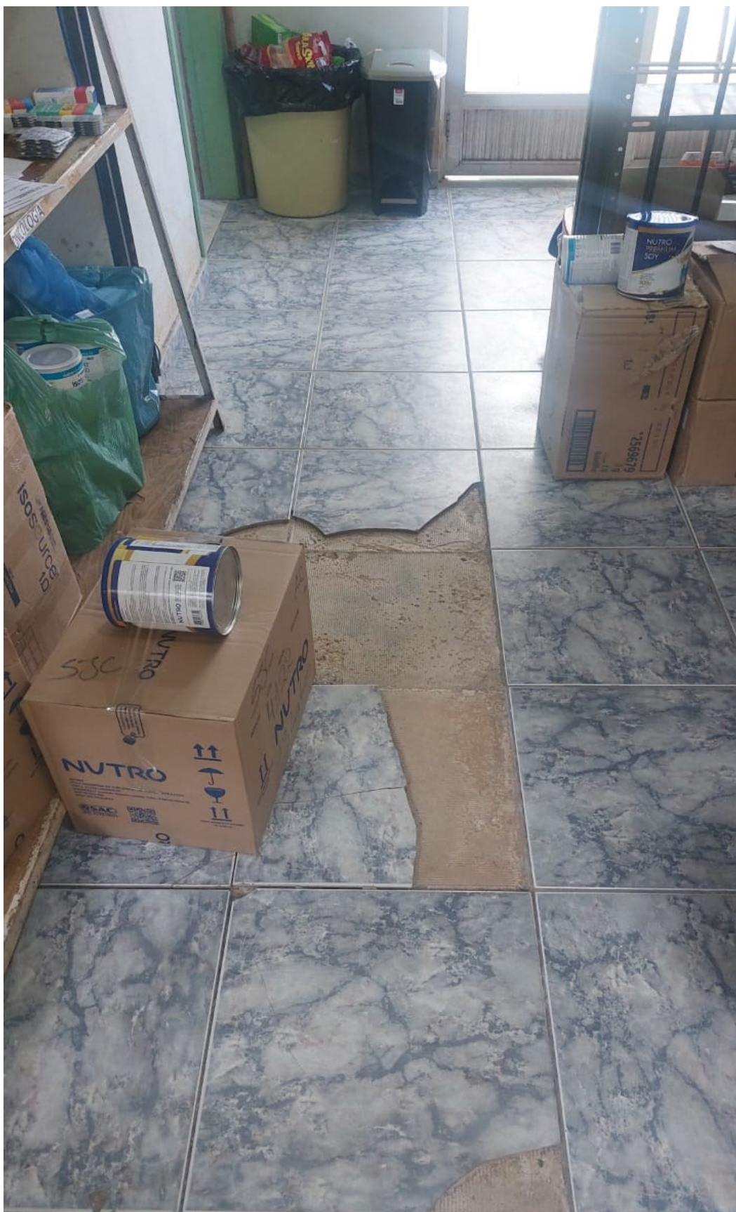
Foto 17 – Ladrilho quebrado no piso quebrado com lixo cheio ao fundo na farmácia de São José do Calçado, na entrada da farmácia municipal de São José do Calçado. Fonte: Elaboração própria, em 18/12/2024.
