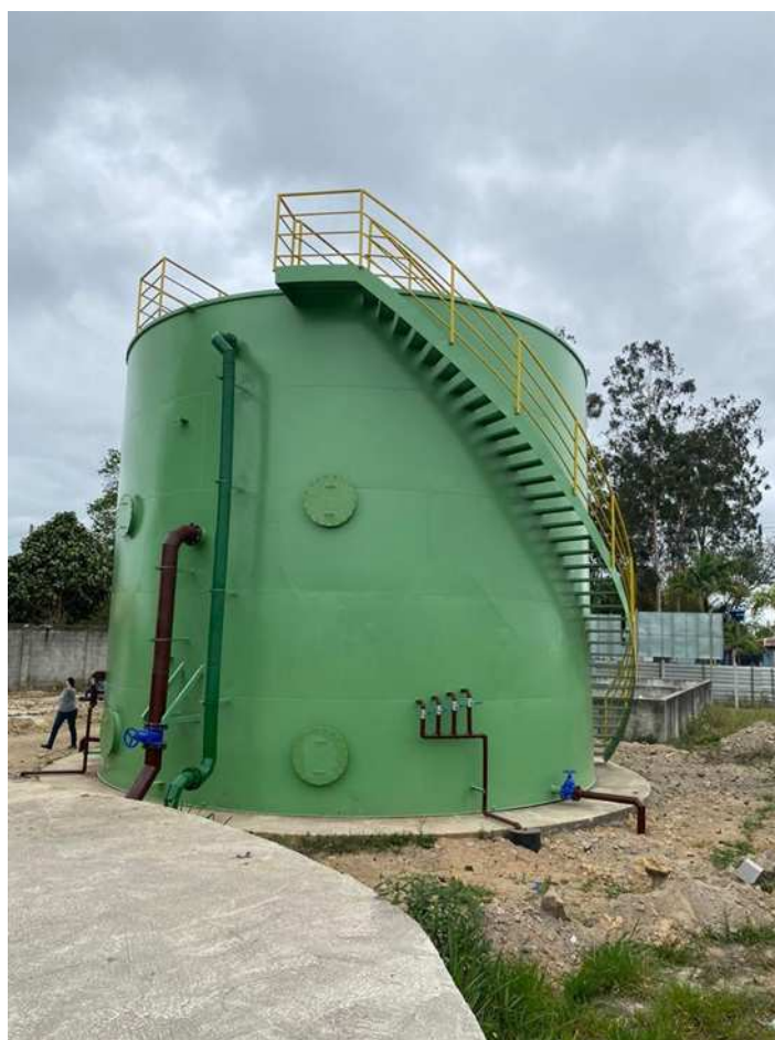
Estação de Tratamento de Esgoto do Bairro Novo Tempo
