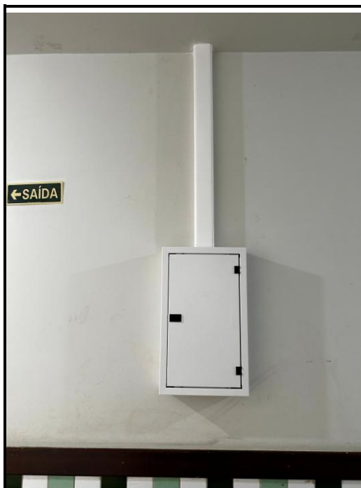
Foto 01: QD1 - Quadro Ar Condicionado
