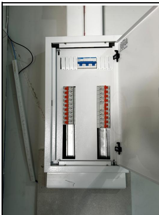
Foto 05: Quadro geral de entrada
