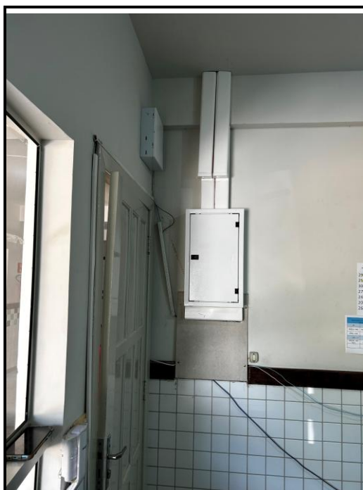
Foto 07: Quadro geral de entrada
