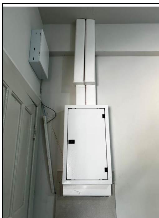
Foto 04: Quadro geral de entrada
