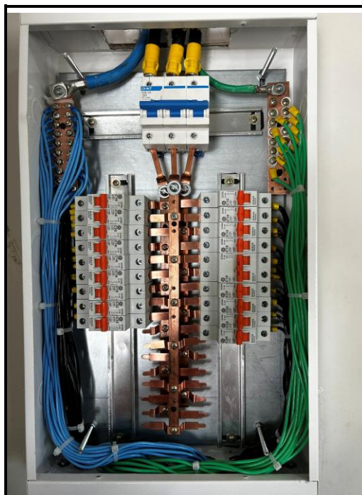
Foto 06: Quadro geral de entrada
