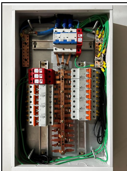
Foto 03: QD1 - Quadro Ar Condicionado
