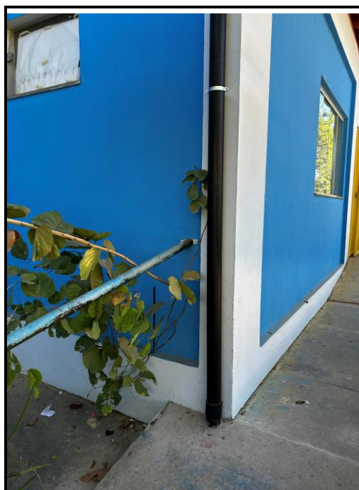
Foto 08: Eletroduto de entrada do quadro geral
