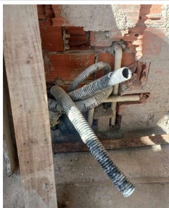
Foto 21: Passagem eletroduto PEAD
