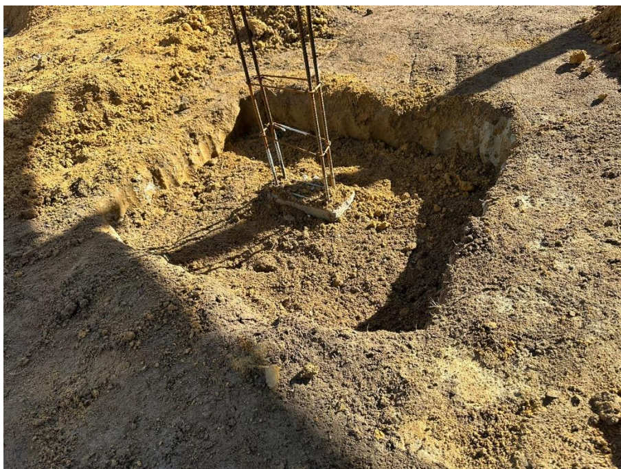
Foto 20 – Sapatas reenterradas (ITENS 03.02 e 19.02)
