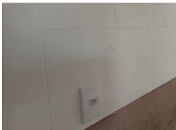
Foto 04 – Instalações elétricas (tomadas).
