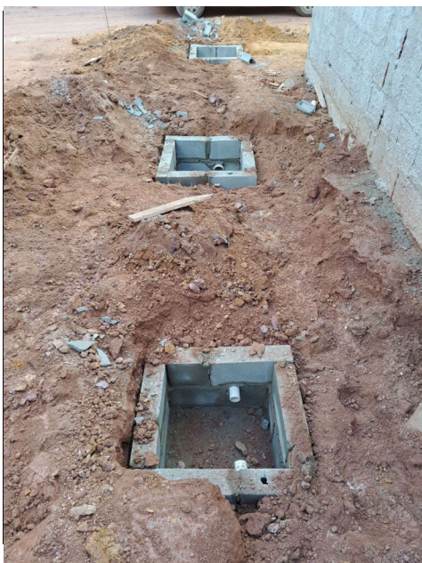
CAIXA DE PASSAGEM EM ALVENARIA
