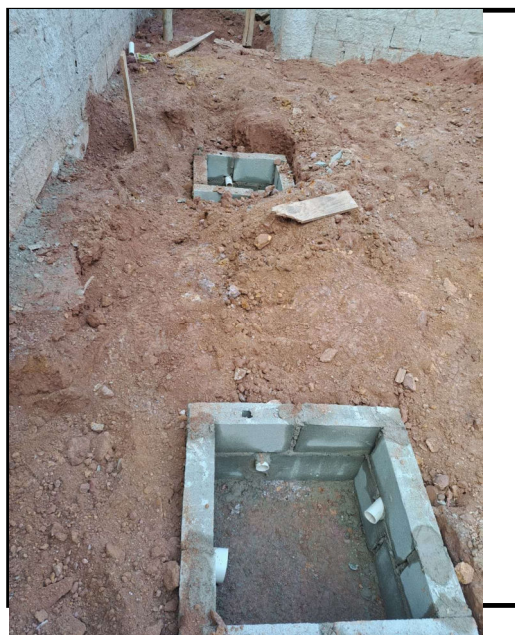
CAIXA DE PASSAGEM EM ALVENARIA
