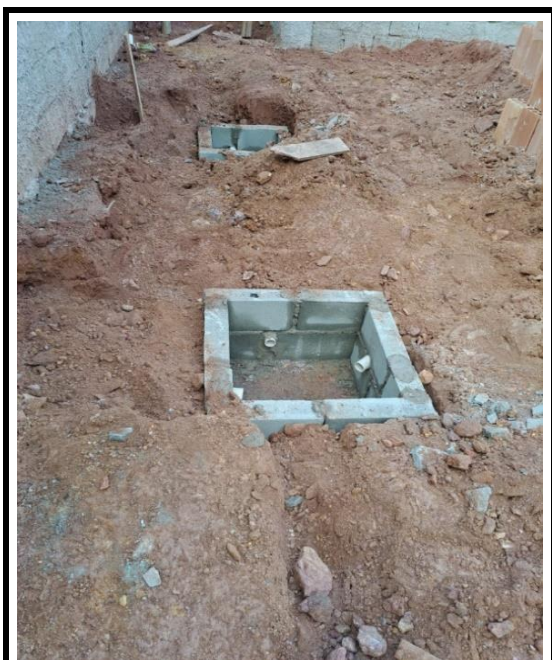
CAIXA DE PASSAGEM EM ALVENARIA
